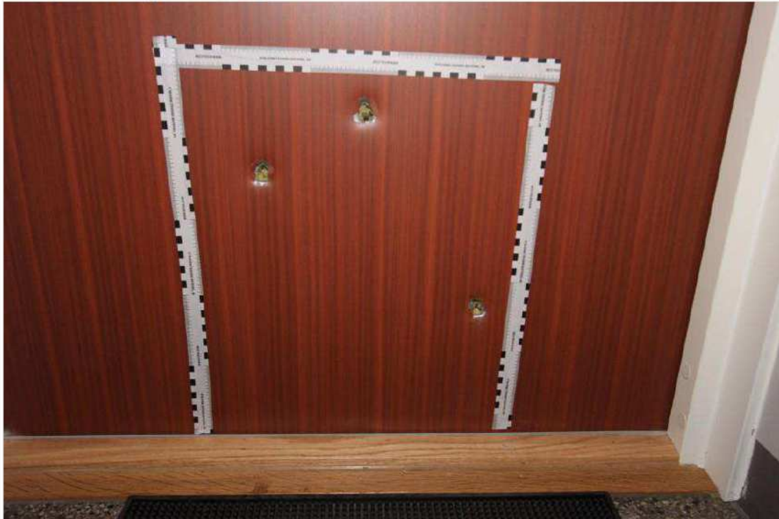
Figur 5. Skadorna på dörrens utsida.
