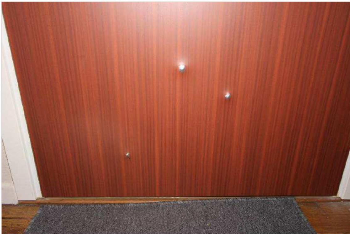
Figur 6. Skadorna/utbuktningarna på dörrbladets insida.
