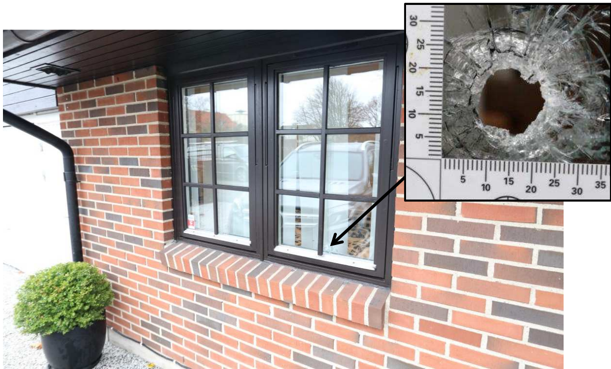
Figur 5. Fönster med närbild på skadan.
