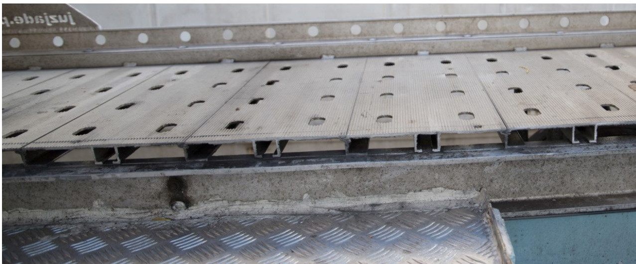
Bild 14. Lastgolvet har sågats upp och resulterat i nio lösa plåttribbor som täckt utrymmet.
