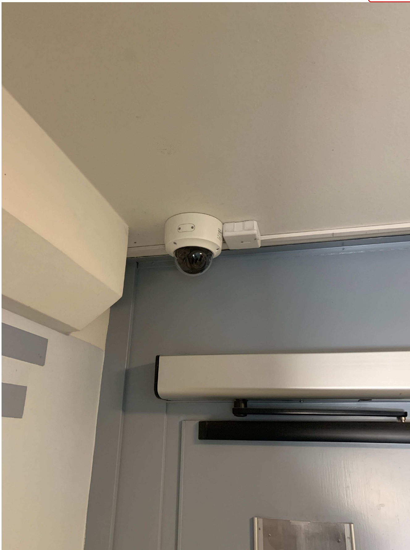
4. Kamera som satt i taket vid entrén till hiss samt trappuppgång.
