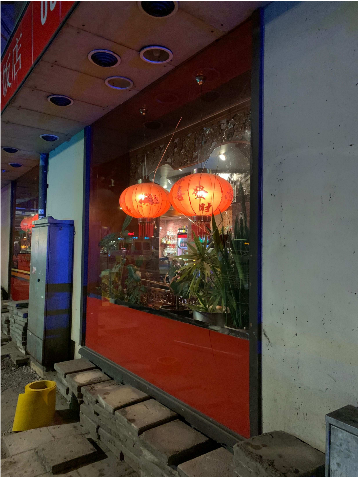
9. Bild på skadad fönsterruta restaurang Hang Chow.
