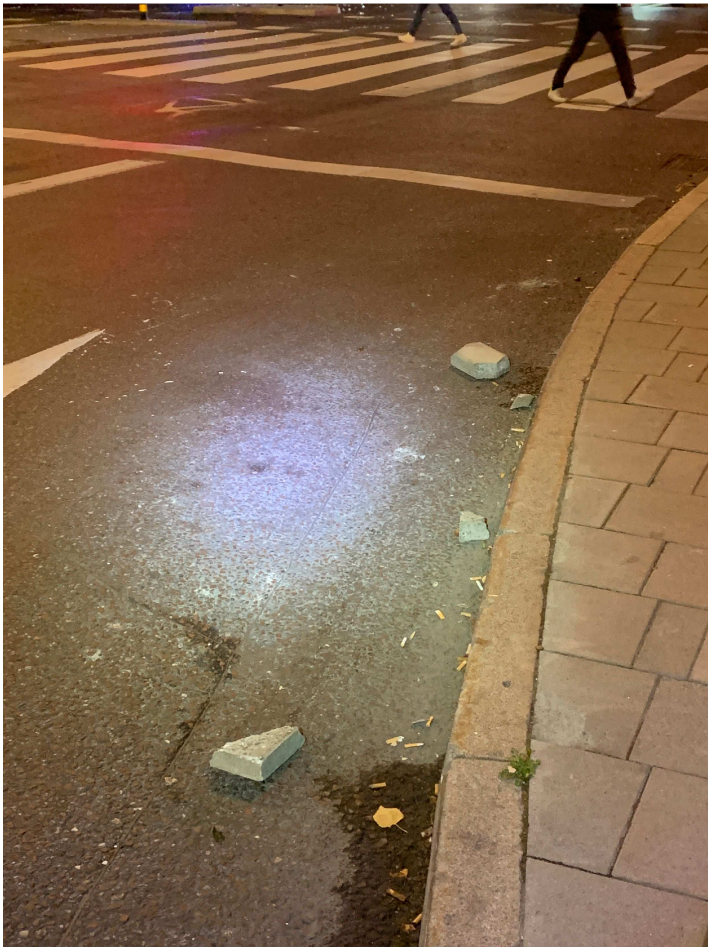
32. Foto på delar av stenplattor på Drottningholmsvägen utanför tunnelbana Fridhemsplan uppgång Drottningholmsvägen.
