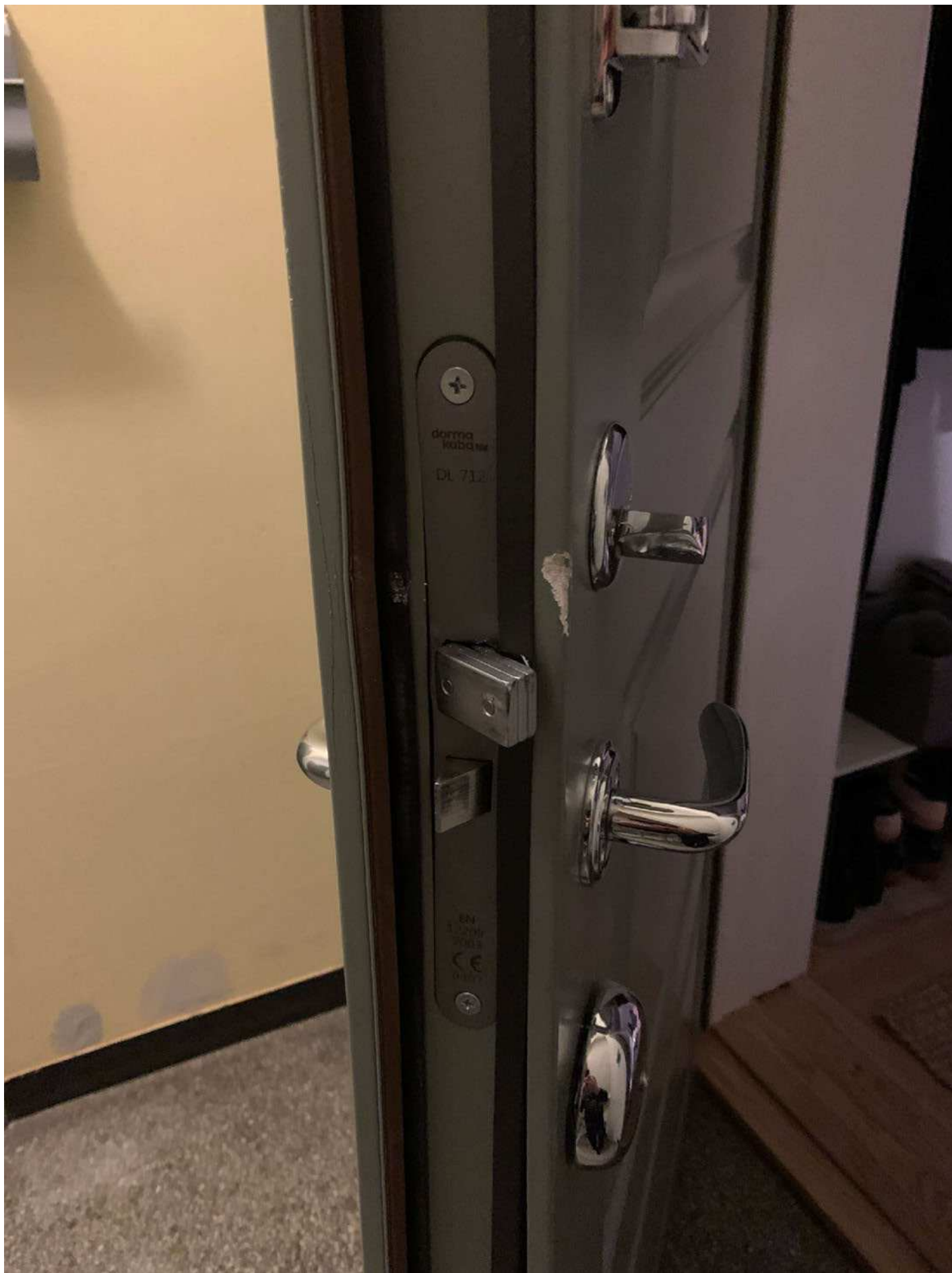
34. Bild på skador på dörren.
