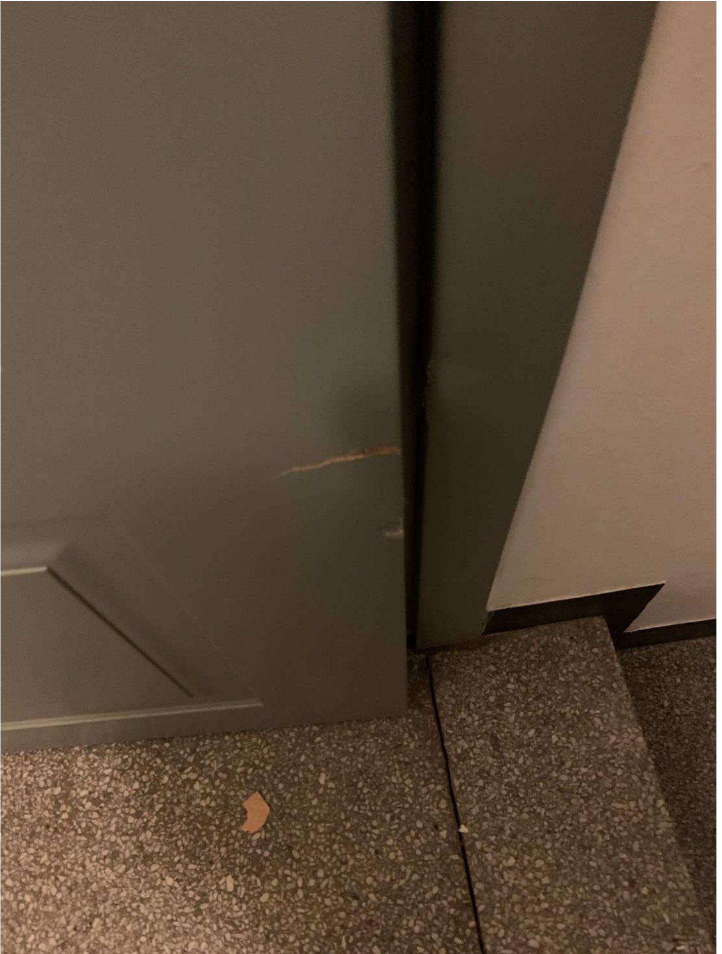
31. Bild på dörren där man kan se skador.
