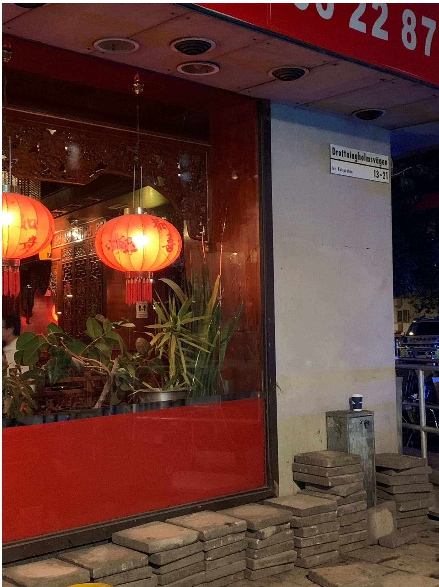
12. Bild på skadad fönsterruta restaurang Hang Chow.
