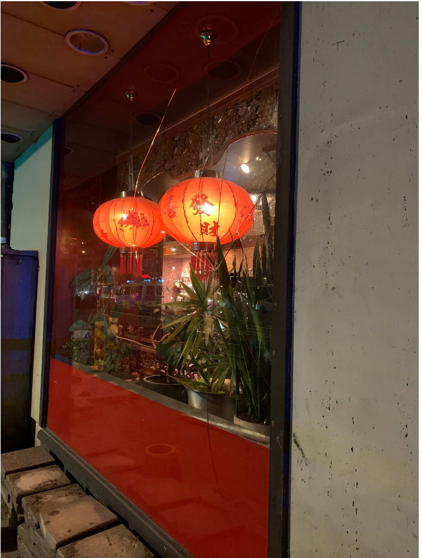
10. Bild på skadad fönsterruta restaurang Hang Chow.
