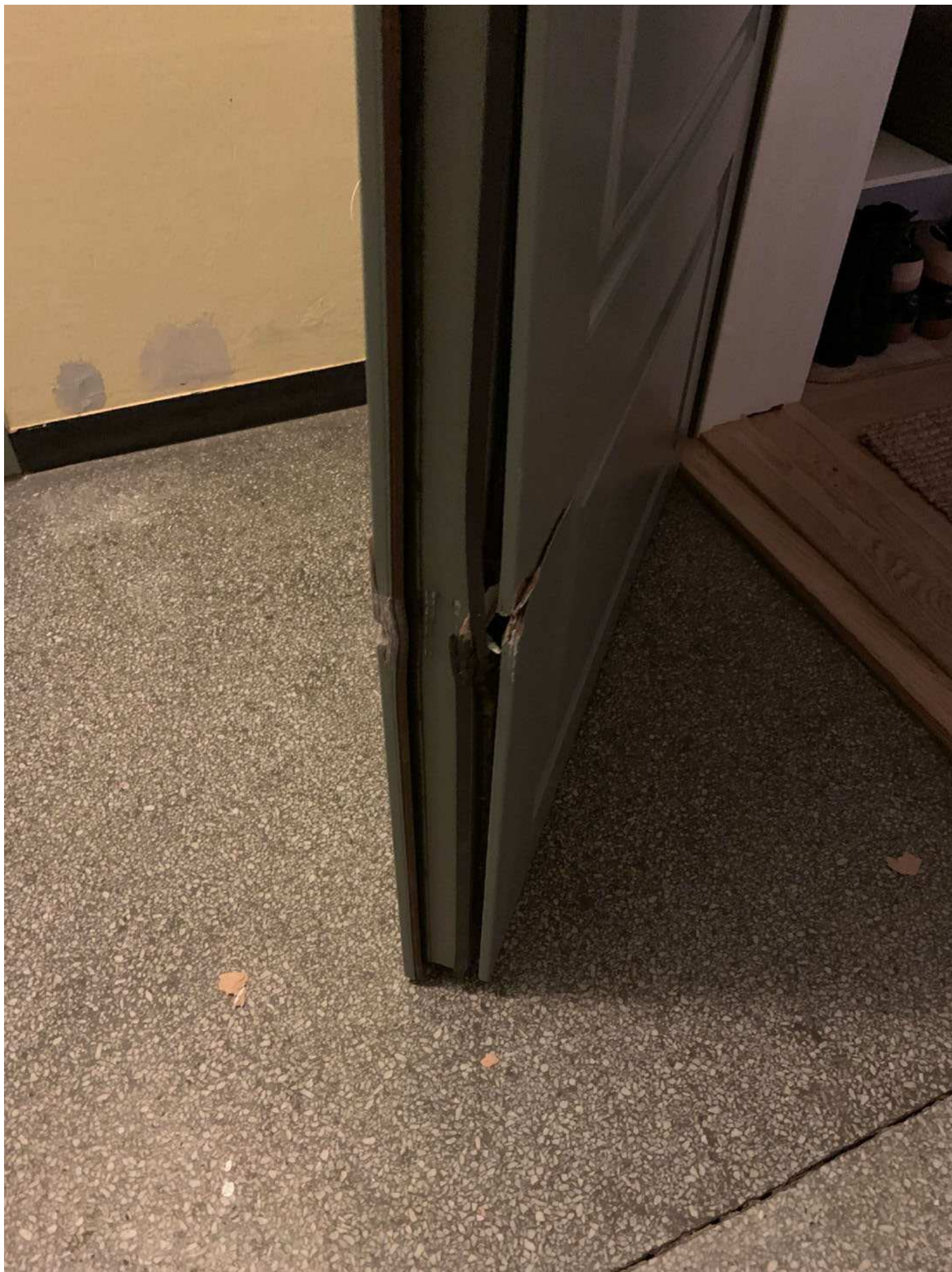
32. Bild på skador på dörren.
