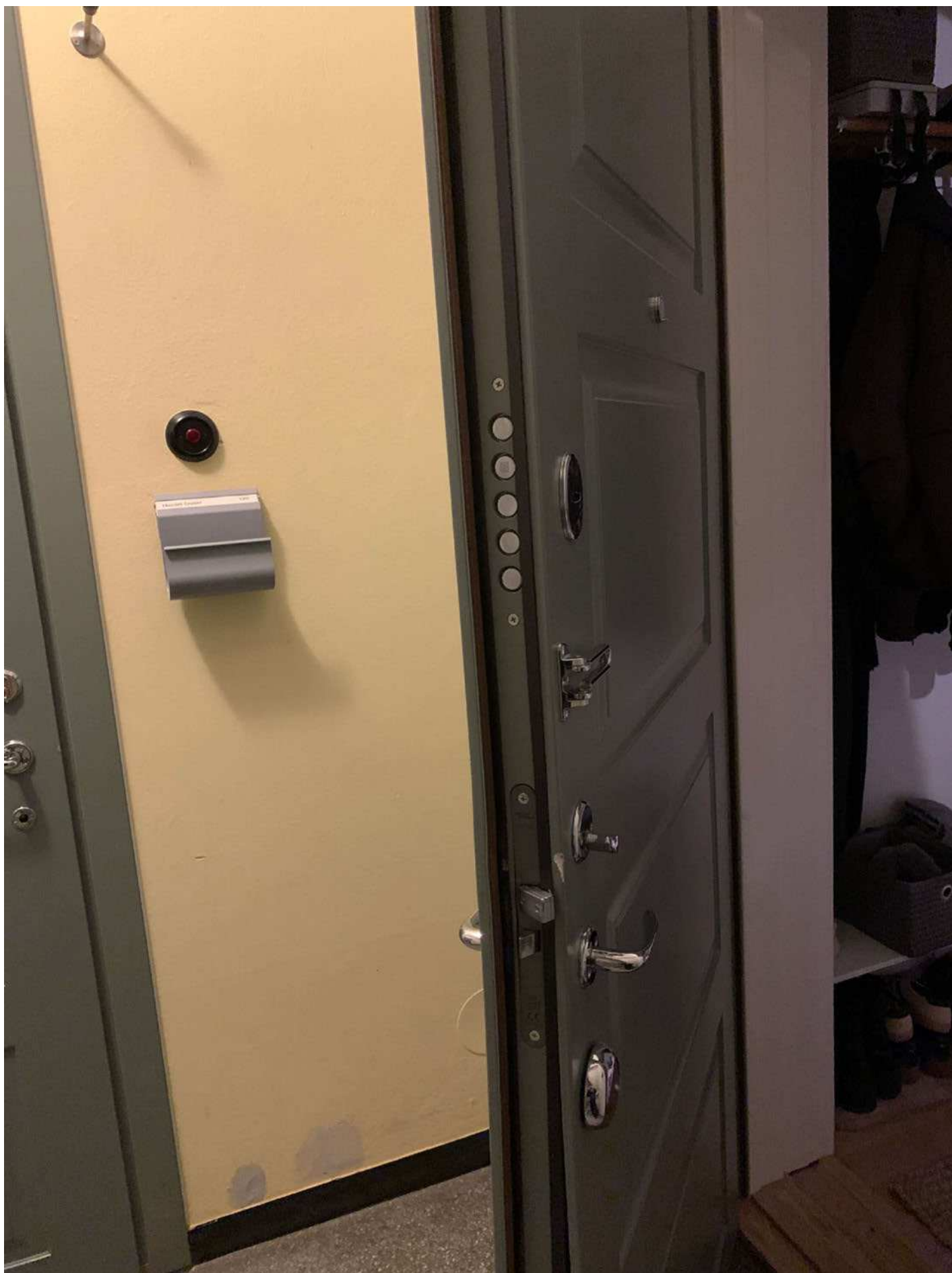
33. Bild på skador på dörren.
