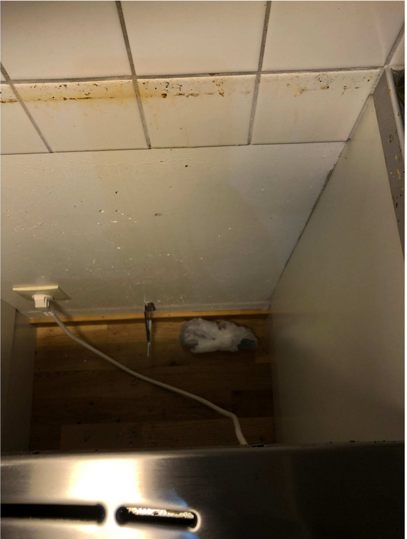
1. Bakom spisen låg en plastpåse på golvet. Vid kontroll av plastpåsen så fanns det en färdig apterad sprängkapsel.
