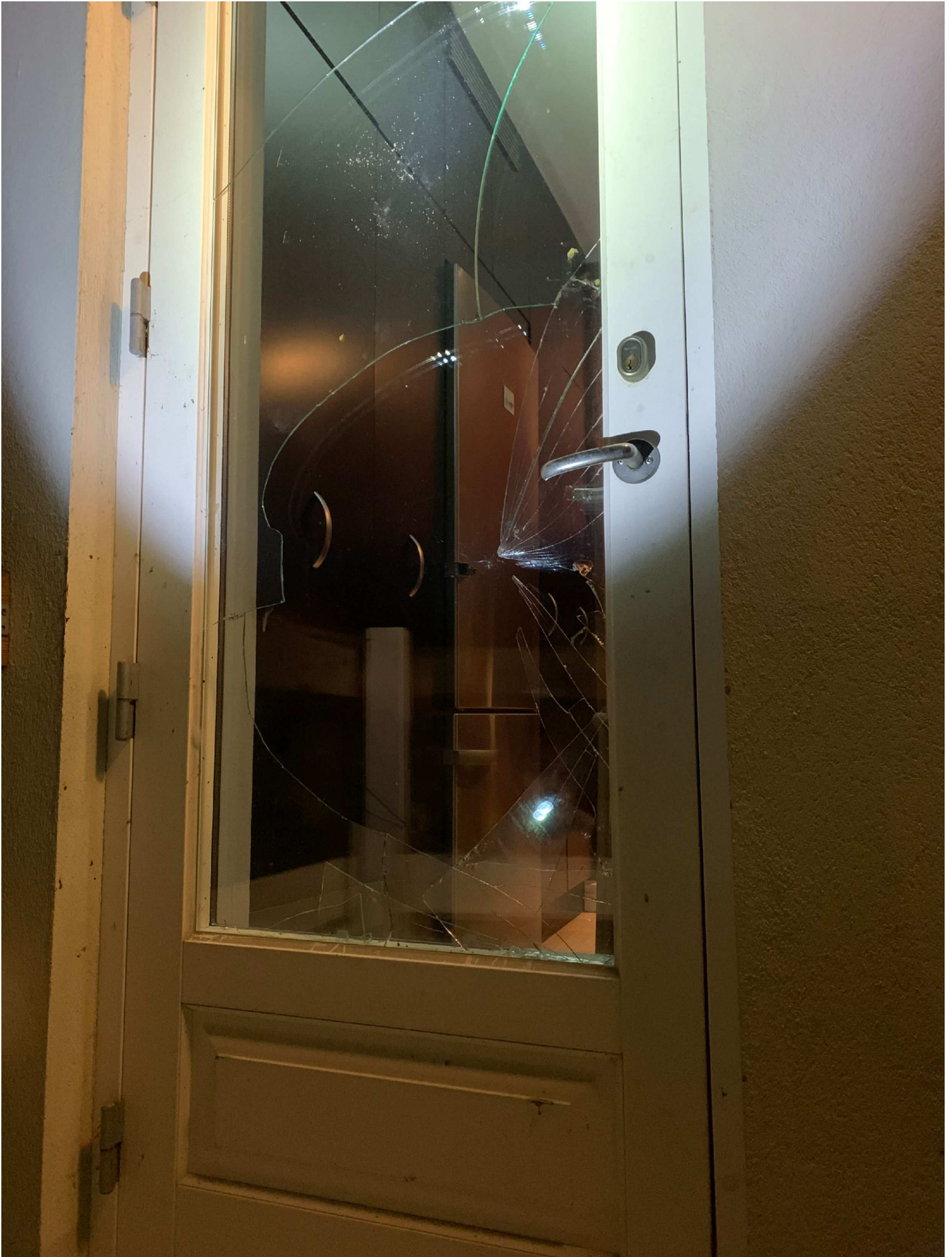
4. Krossat fönster på terrassdörr.
