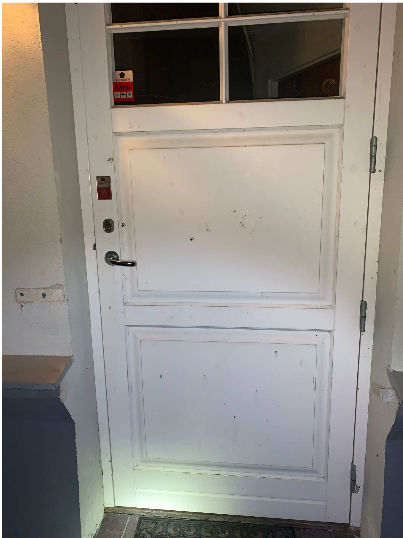
7. ytterligare en dörr till huset på baksidan som Blazej bankat på. Inga synliga skador, men smuts på dörren.
