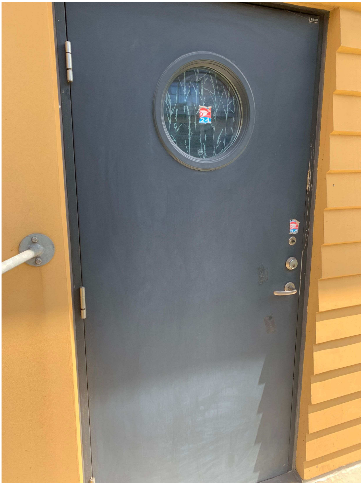
4. Skador på ytterdörr i samband med att insatsstyrkan forcerade dörren. Avser Klyvaregränd 2 Malmö, Lgh 1013-1201.
