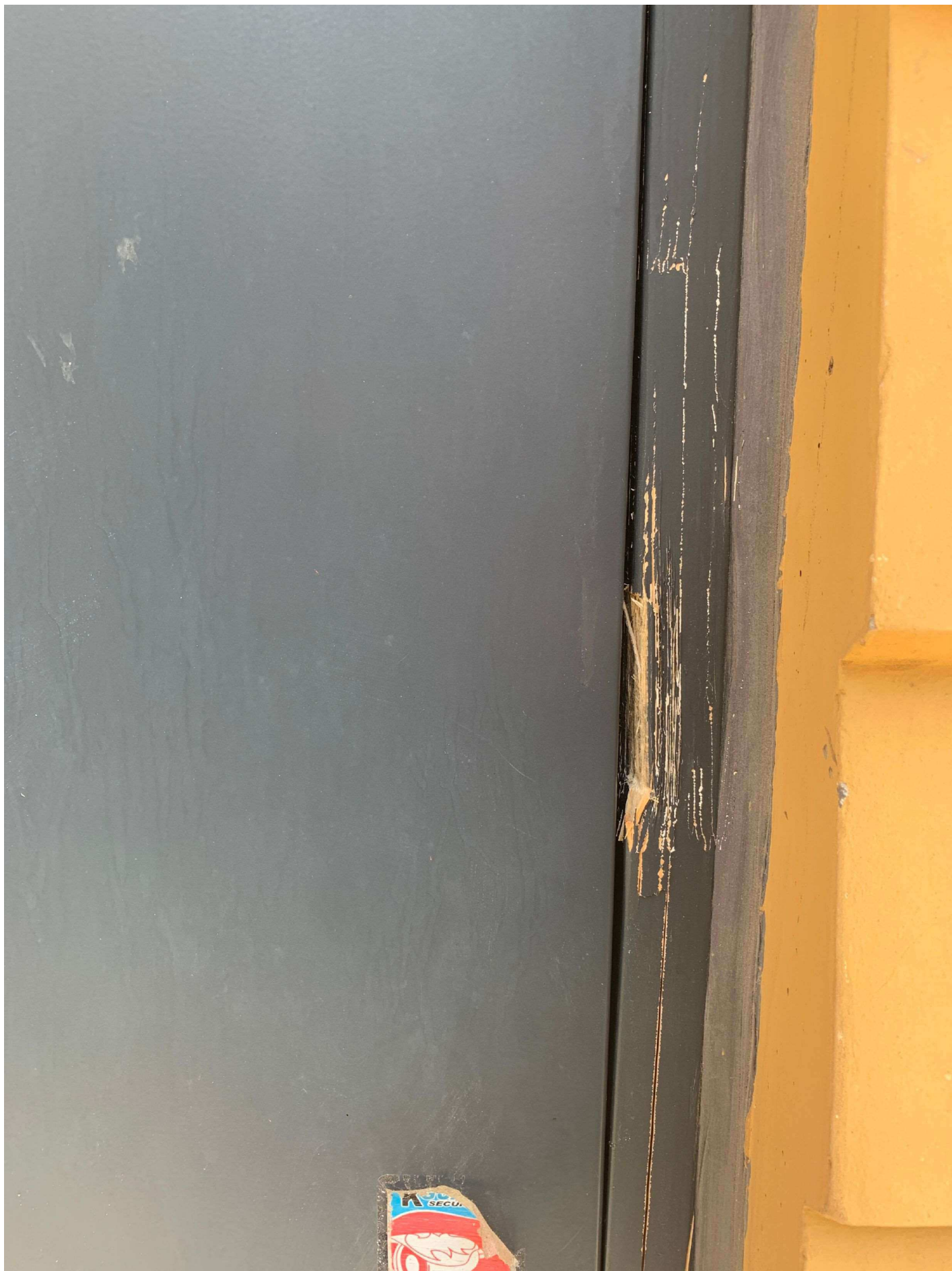
1. Skador på ytterdörr i samband med att insatsstyrkan forcerade dörren. Avser Klyvaregränd 2 Malmö, Lgh 1013-1201.
