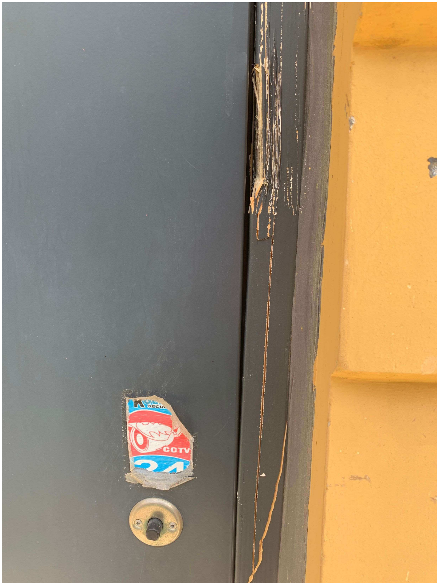
2. Skador på ytterdörr i samband med att insatsstyrkan forcerade dörren. Avser Klyvaregränd 2 Malmö, Lgh 1013-1201.
