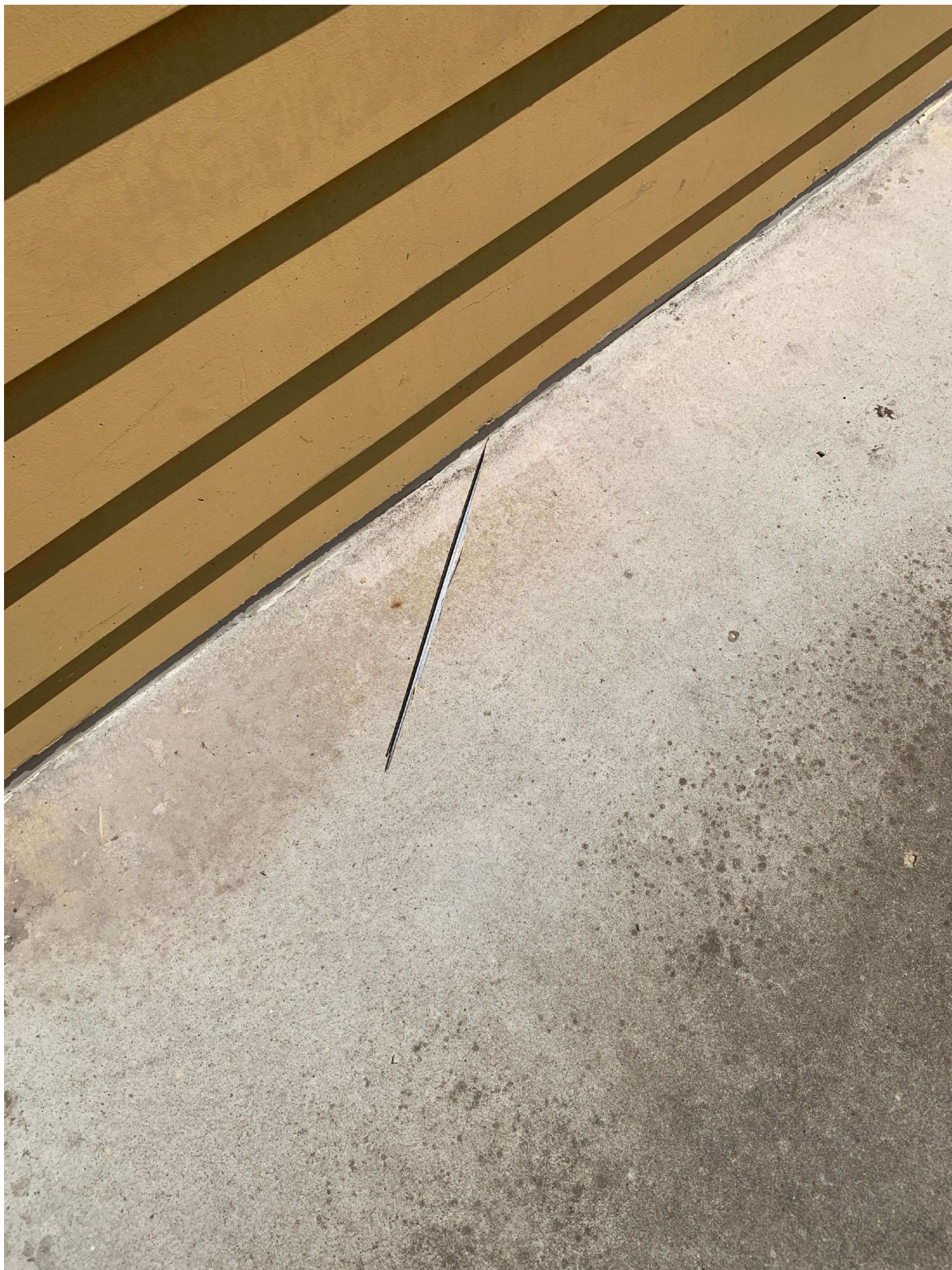
3. Skador på ytterdörr i samband med att insatsstyrkan forcerade dörren. Avser Klyvaregränd 2 Malmö, Lgh 1013-1201.
