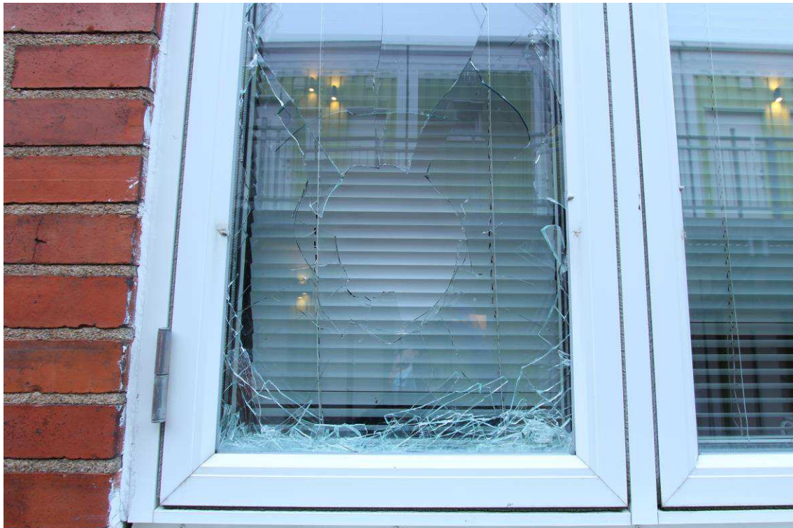
Figur 7. Hålet i fönsterrutan.
