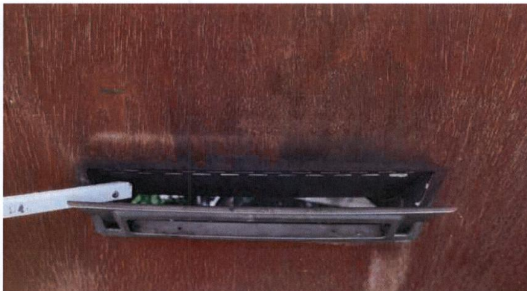
Bild 7 Sotskador på dörrbladet och inne i brevlådeinkastet. Bilden tagen från utsidan med brevlådeinkastets ytterlucka i utfällt läge.
