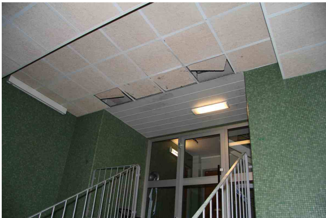
Bild 16. Takskivorna ovanför trappan låg i oordning.
