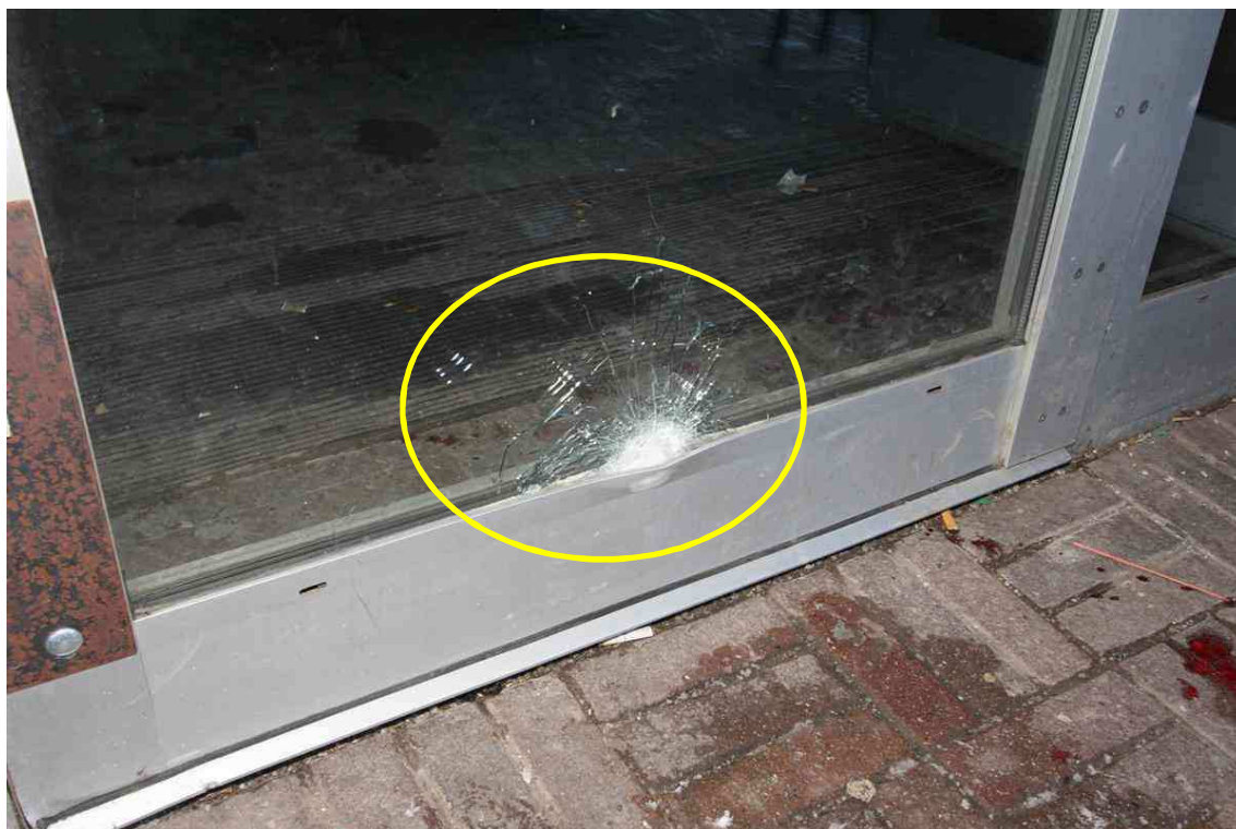
Bild 4. Ovankanten på den nedre dörrplåten buktade utåt. Ovanför utbuktningen var glaset krossat. Skadan är markerad på bilden.
