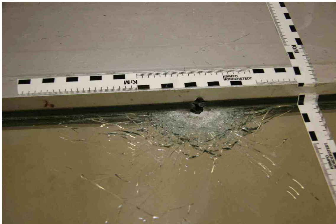
Bild 19. Den nedre skadan på dörren var i glaset och kanten på metallramen.
