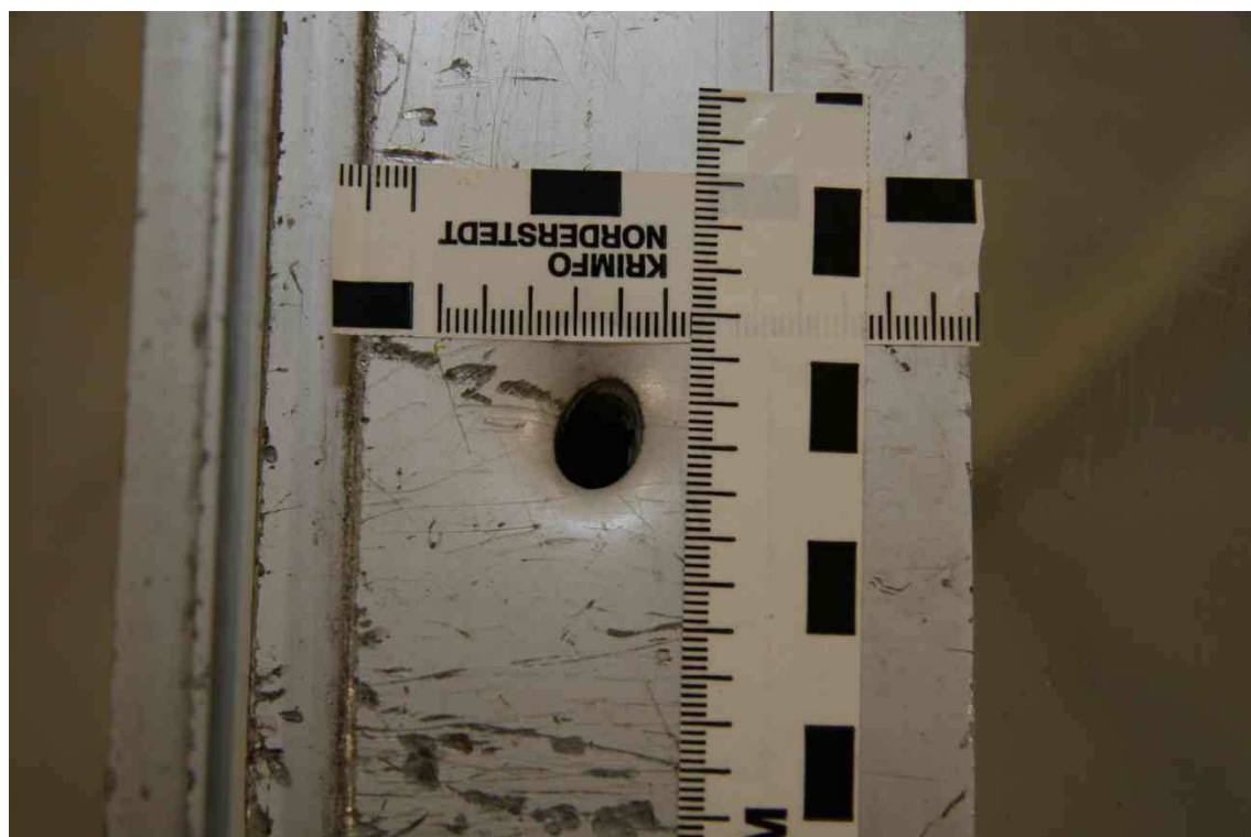
Bild 22. Den övre skadan på dörren.
