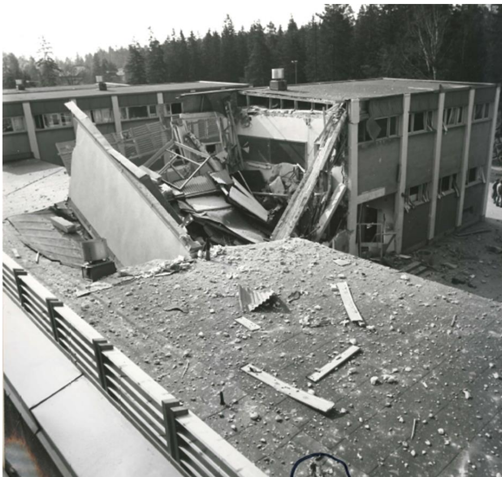
Figur 3. Foto på skador efter detonation. Källbrinksskolan i Huddinge, 1978.
