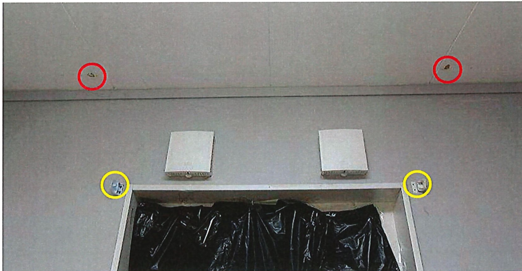
Figur 16. Översiktsbild över taket ovanför fönstret i sovrummet. De röda cirklarna visar skadorna efter fästena till gardinstången. De gula cirklarna visar fästena till eventuellt en rullgardin.
