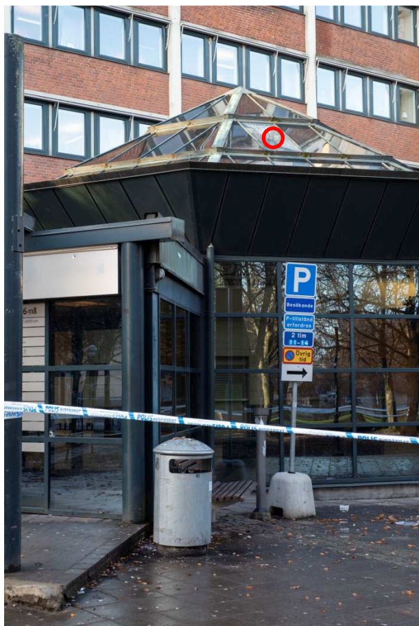
Bild 8. Cirkeln markerar skottskada i glaskupolen över entrén.
