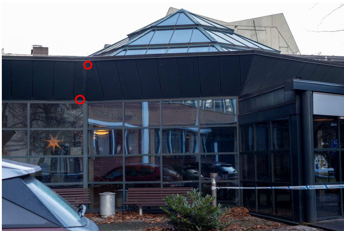
Bild 6. De två cirkklarna markerar skottskador i fasaden till vänster om entrén Slottsgatan 116-118.
