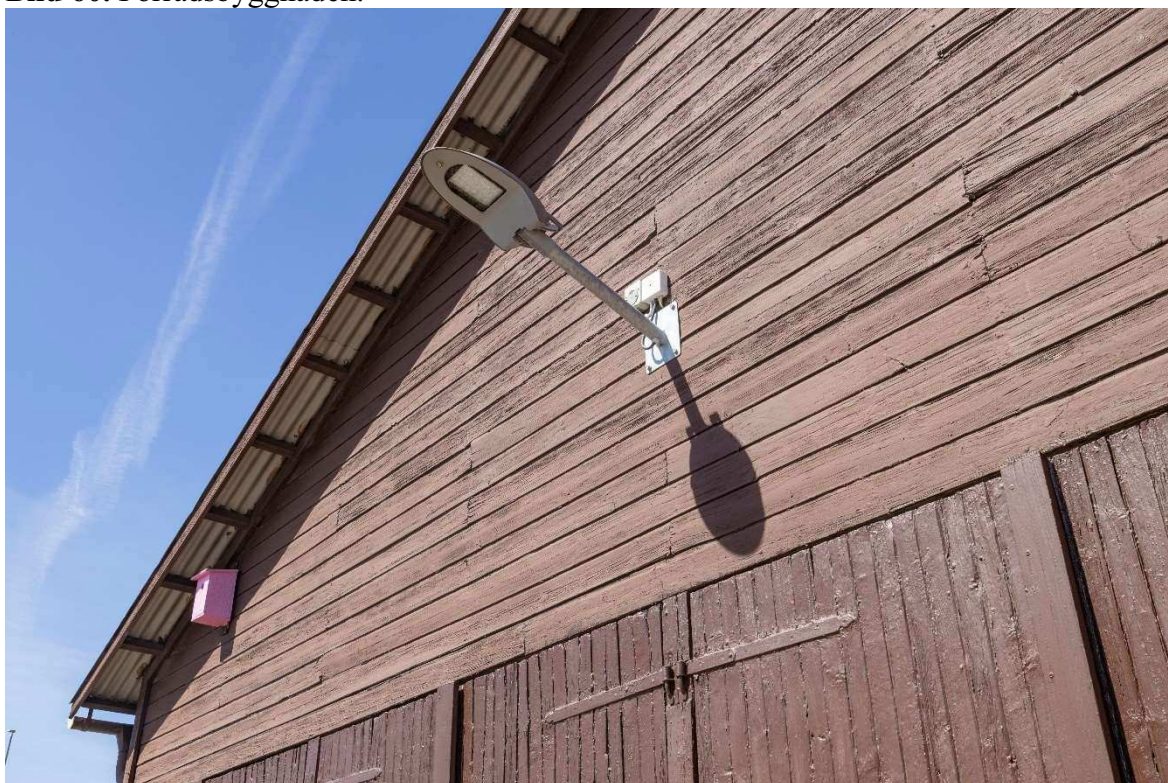
Bild 61. Förrådsbyggnaden, belysningsarmatur på ena gaveln.
