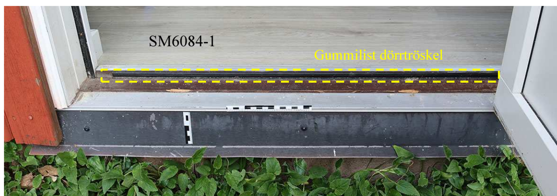
Figur 21. På bilden ses ytorna på tröskeln som täcks av altandörren i stängt läge. Området var delar av det säkrade området SM6084-1. På bilden är området som benämndes som "gummilist dörrtröskel" markerat.
