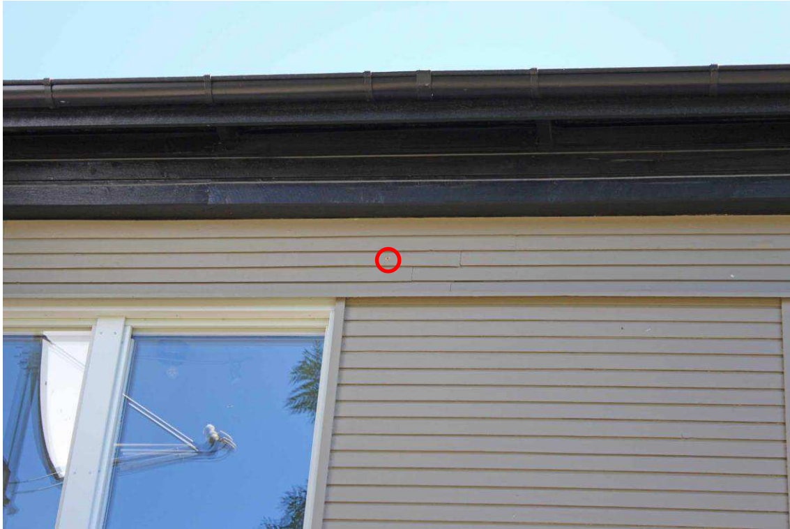
Bild 13. Vad som från marken bedömts vara ett kulhål, beläget högt upp på fasaden till bostadsfastigheten Skaldegatan 17, har markerats med en cirkel.
