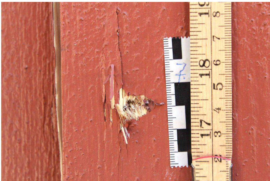
Bild 12. Ett av kulhålen i förrådsväggen.
