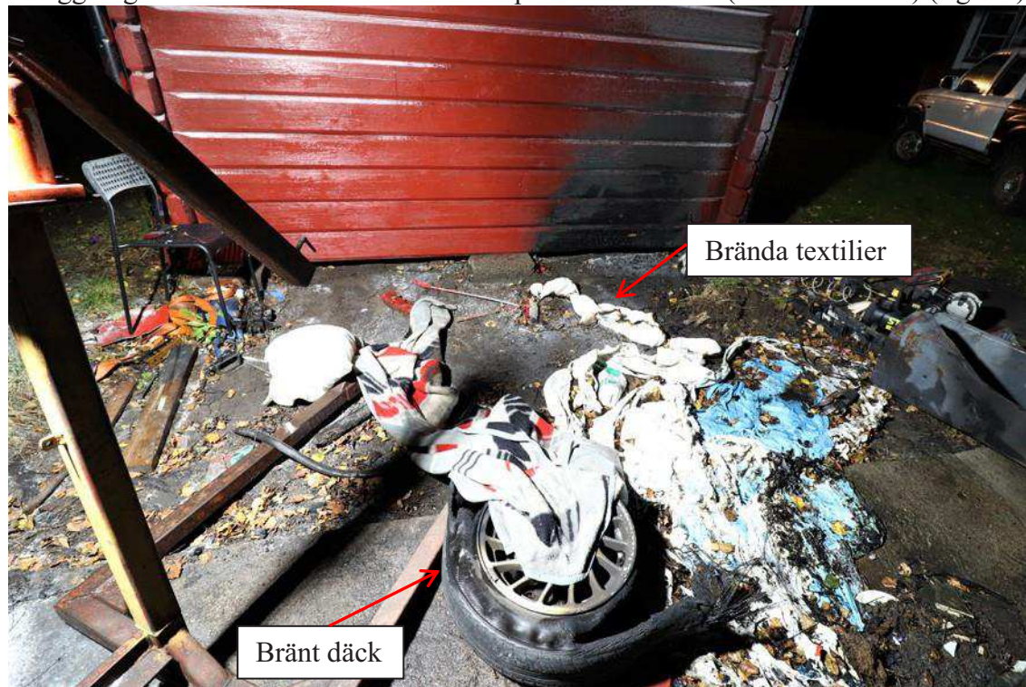
Figur 7. Däcket och textilt material som uppvisade tecken på brand.
