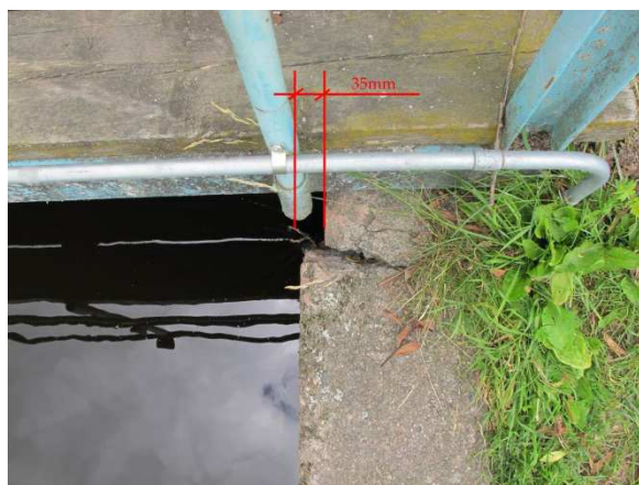
Bild 1 – Bild på höger anslutning och sprickan som blivit då muren rört sig ut i dammen.
