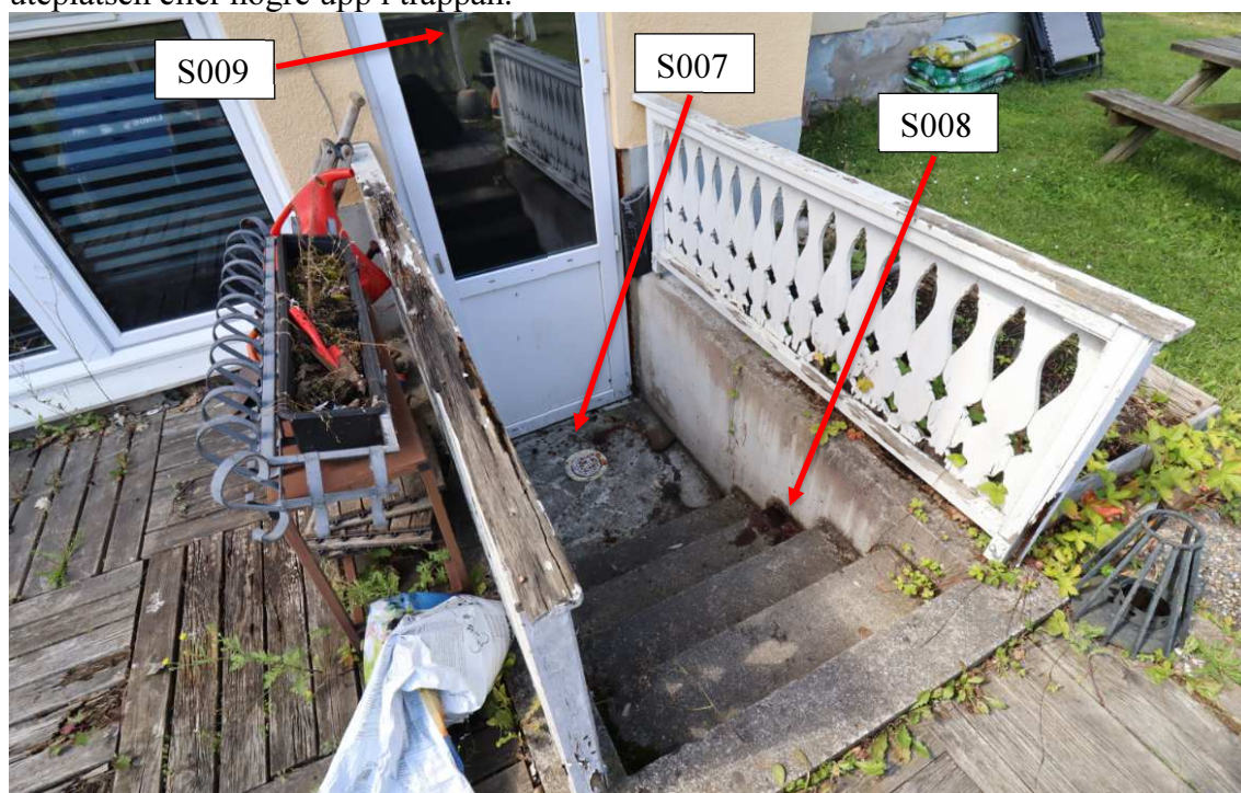
Figur 13: Betongtrappan vid altandörren på byggnadens baksida. Röda pilar med textrutor markerar vart blod S007 - S009 säkrats.
