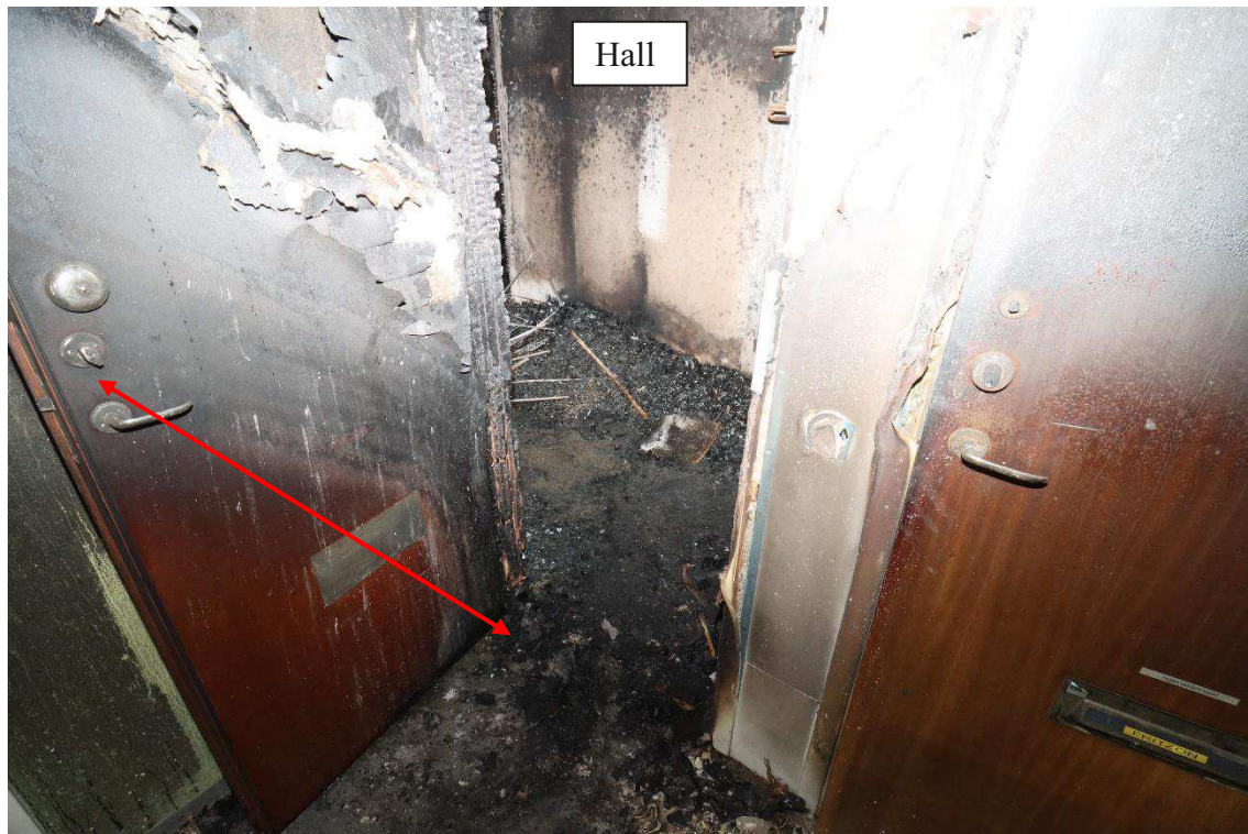
Figur 12. Närbild på innerdörr. Röd pil visar den sneda förbränningen nertill på insidan av ytterdörren till lägenhet 1001.
