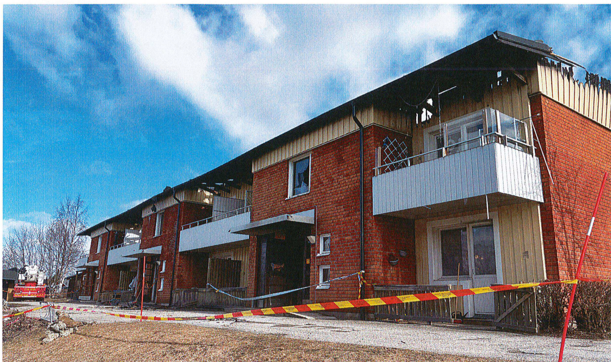
Figur 1 visar entréfasad på branddrabbad byggnad. Foto taget av undertecknad vid platsbesök 2025-04-09.
