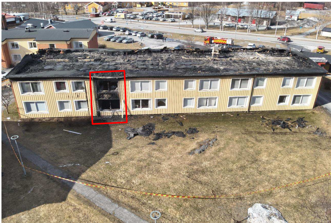
Figur 8. Bilden visar taket på Solbacken 2 Strömsund, baksidan. Aktuell lägenhet, samt lägenheten ovanför markerade i bild (UAS-bild från FILIP).
