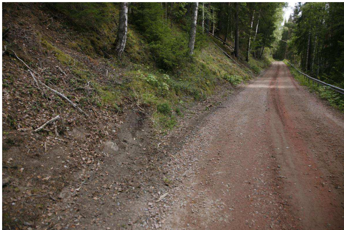
Figur 7. Del av vägen som leder från Holmstaområdet ner till Indalsälven. Där iakttogs dels hjulspår samt skador på terrängen vid sidan av vägen (till vänster i bild), dels riv-/sladdspår på vägen.
