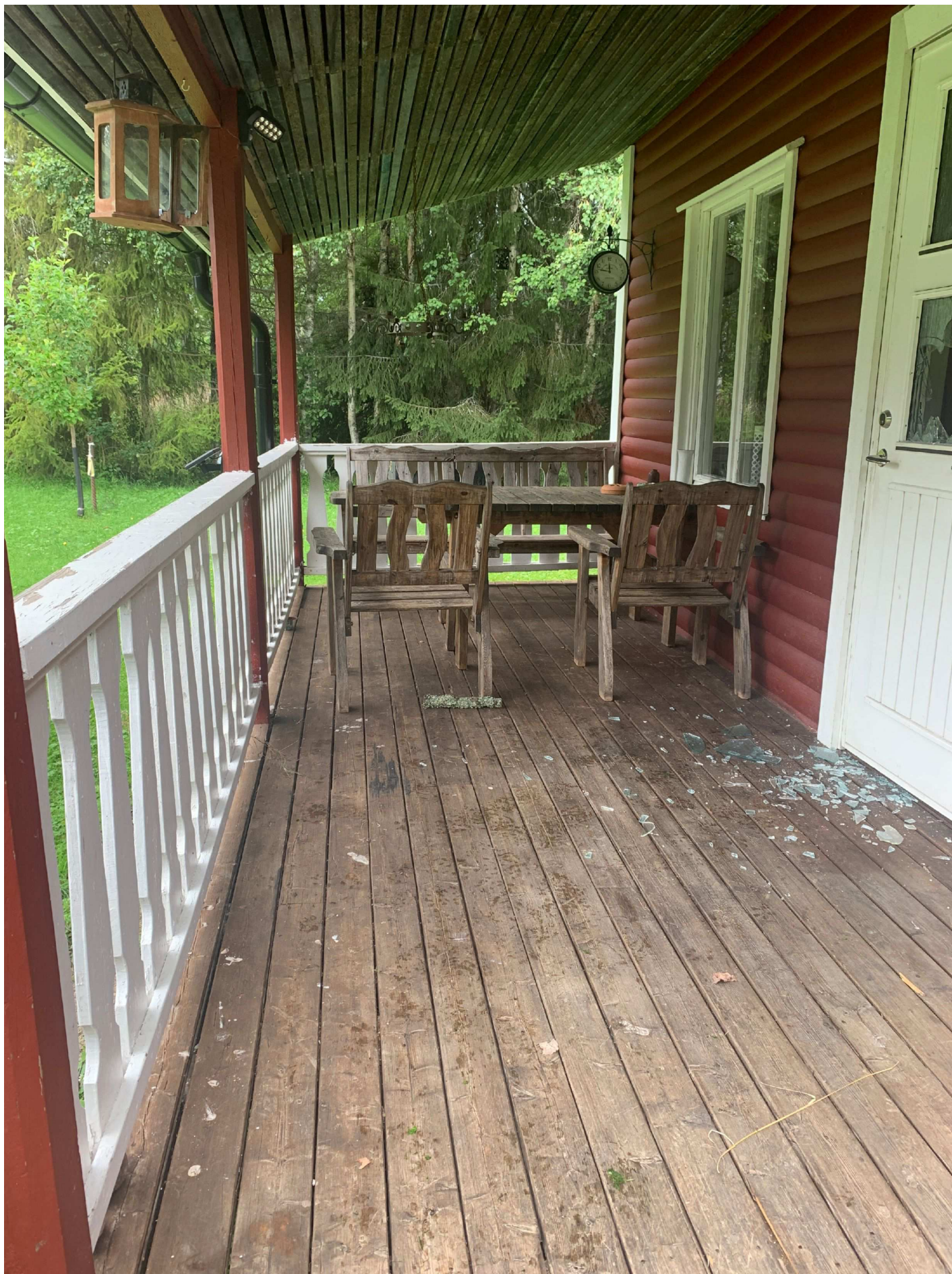
2. Entrén till stugan. Glasrutan på ytterdörren krossad, glassplitter på verandan nedanför dörren.
