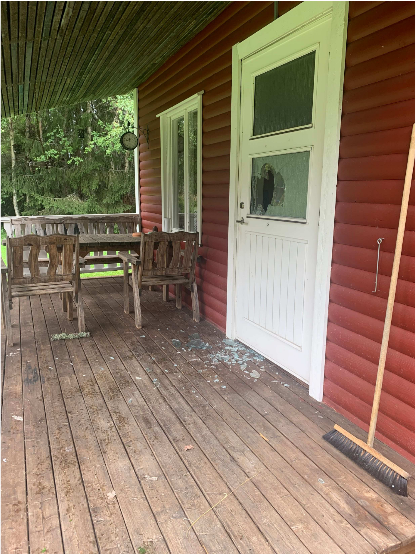
1. Entrén till stugan. Glasrutan på ytterdörren krossad, glassplitter på verandan nedanför dörren.
