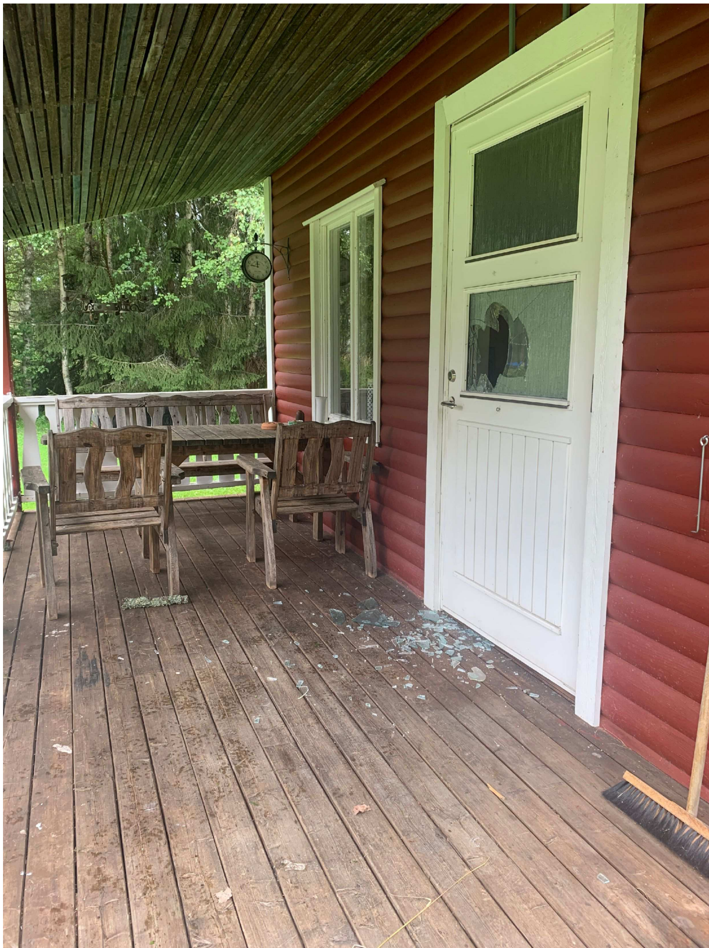
3. Entrén till stugan. Glasrutan på ytterdörren krossad, glassplitter på verandan nedanför dörren.
