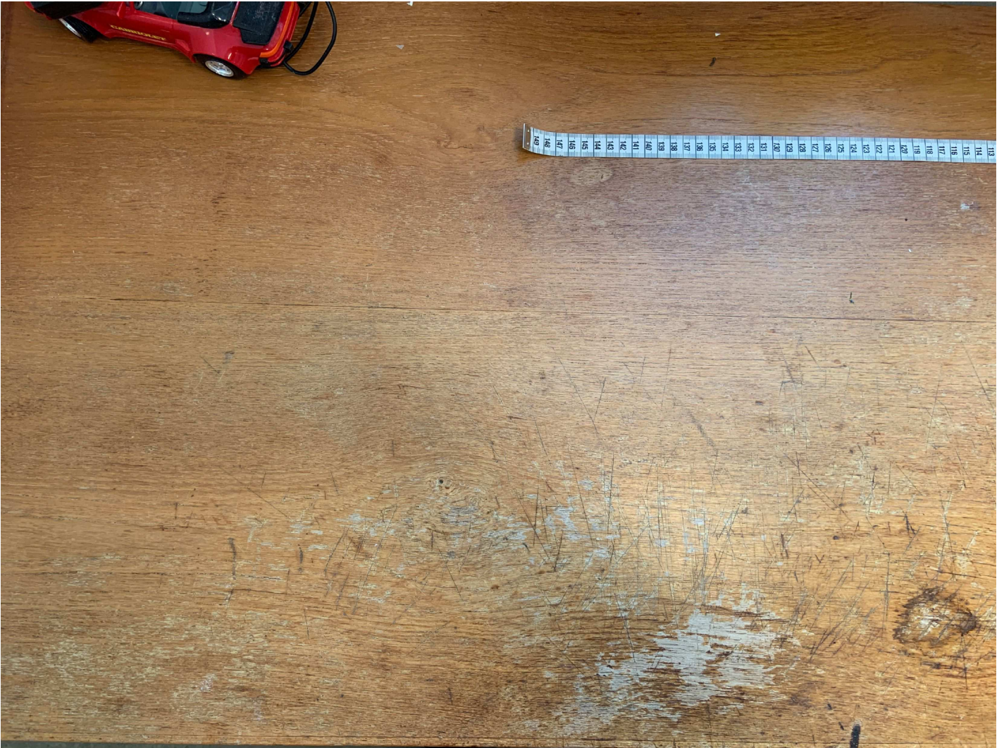
10. Bänkskivan under fönstret från ca mitten och mot vänstra sidan, mot kylskåpet.
