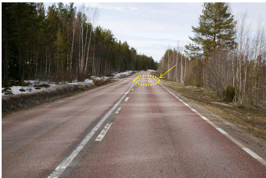
Figur 4. (Bild 6753) Samma vägsträcka som ovan, närmare platsen för ojämnheter i vägbanan, som är inom det inringade området som pilen visar mot. Det finns en avtagsväg till vänster om detta område.
