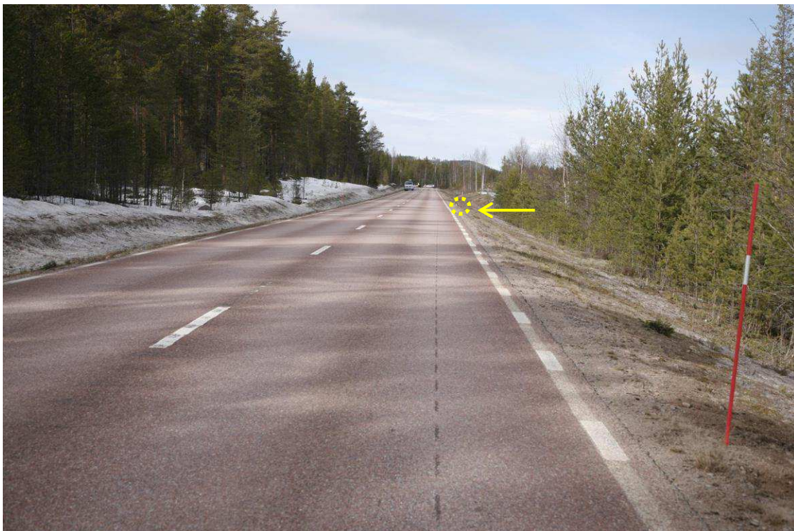
Figur 8. (Bild 6710) Markeringen visar vart däckspåren utanför vägbanan börjar, den s.k. nollpunkten. Vid sträckan innan nollpunkten, kunde inga ojämnheter eller färskas spår från eventuella läckage från vätskor eller liknande iakttas.
