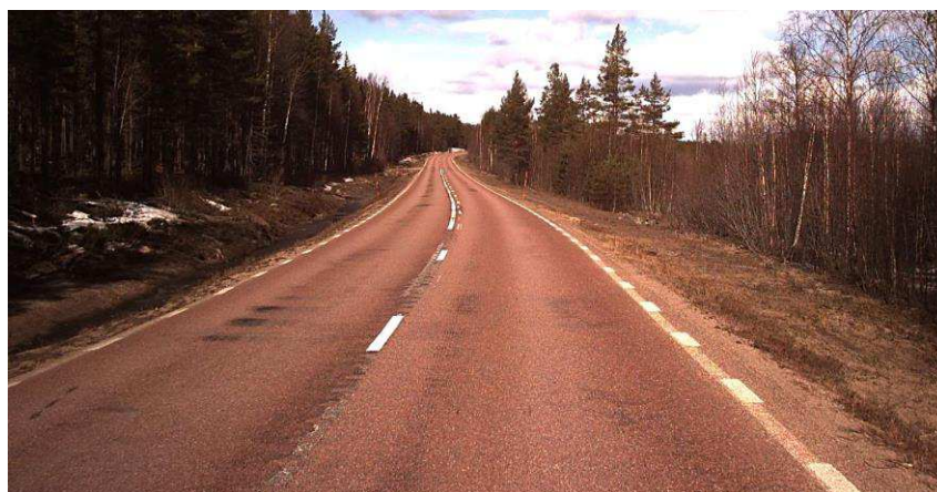
Figur 16: Måttliga ytskador med förhöjd Megatextur, sektion N 10 215 m
