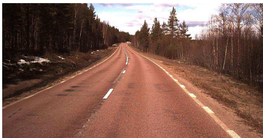
Figur 18: Måttliga ytskador med förhöjd Megatextur, sektion N 10 215 m
