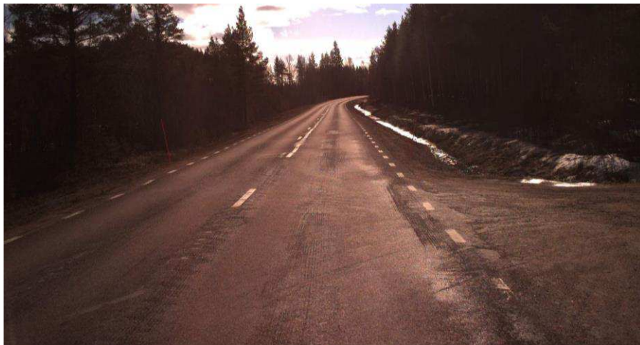
Figur 18: Blank asfalt i yttre hjulspåret, E45S sektion 10 400 m
