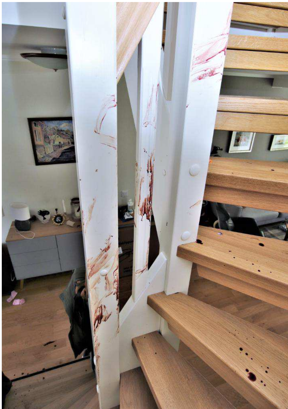
Figur 15. Kontaktsår i blod på stolpar och spjälor i trappen till övervåningen.
