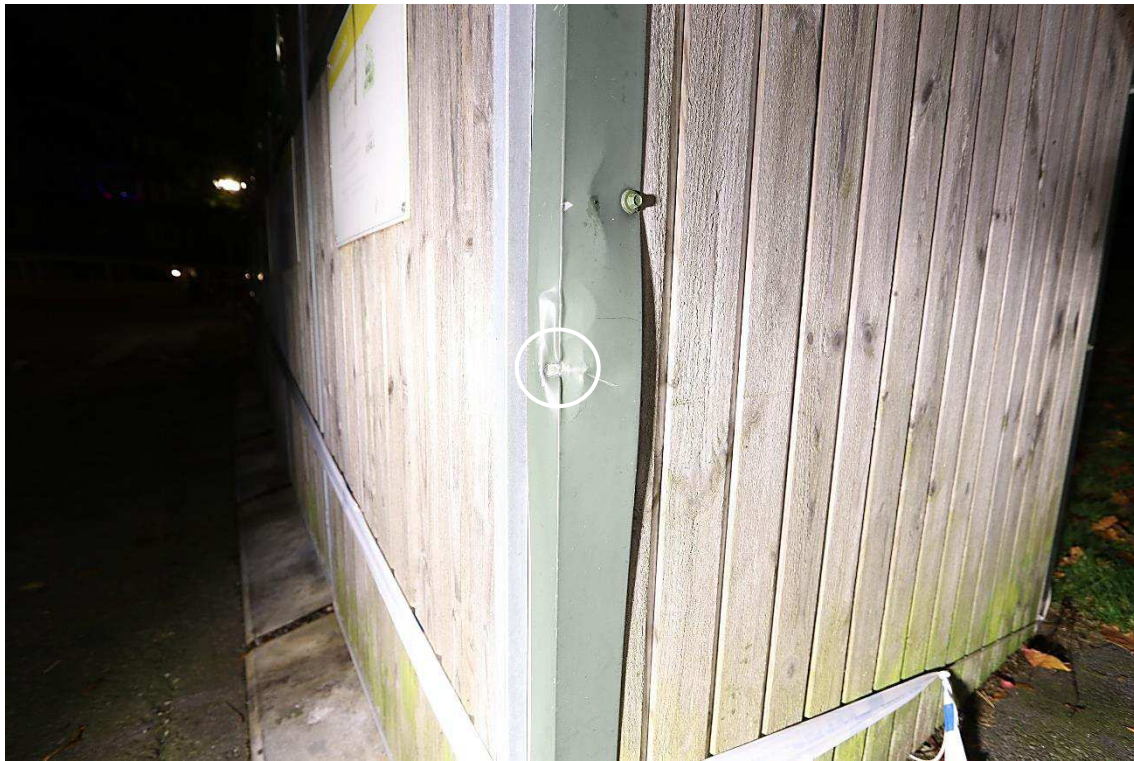
Figur 14. Skada på sophusets yttre hörna på kortsidan som vetter mot infarten och Myntstigen 16. Till vänster i bild är sophusets framsida.
