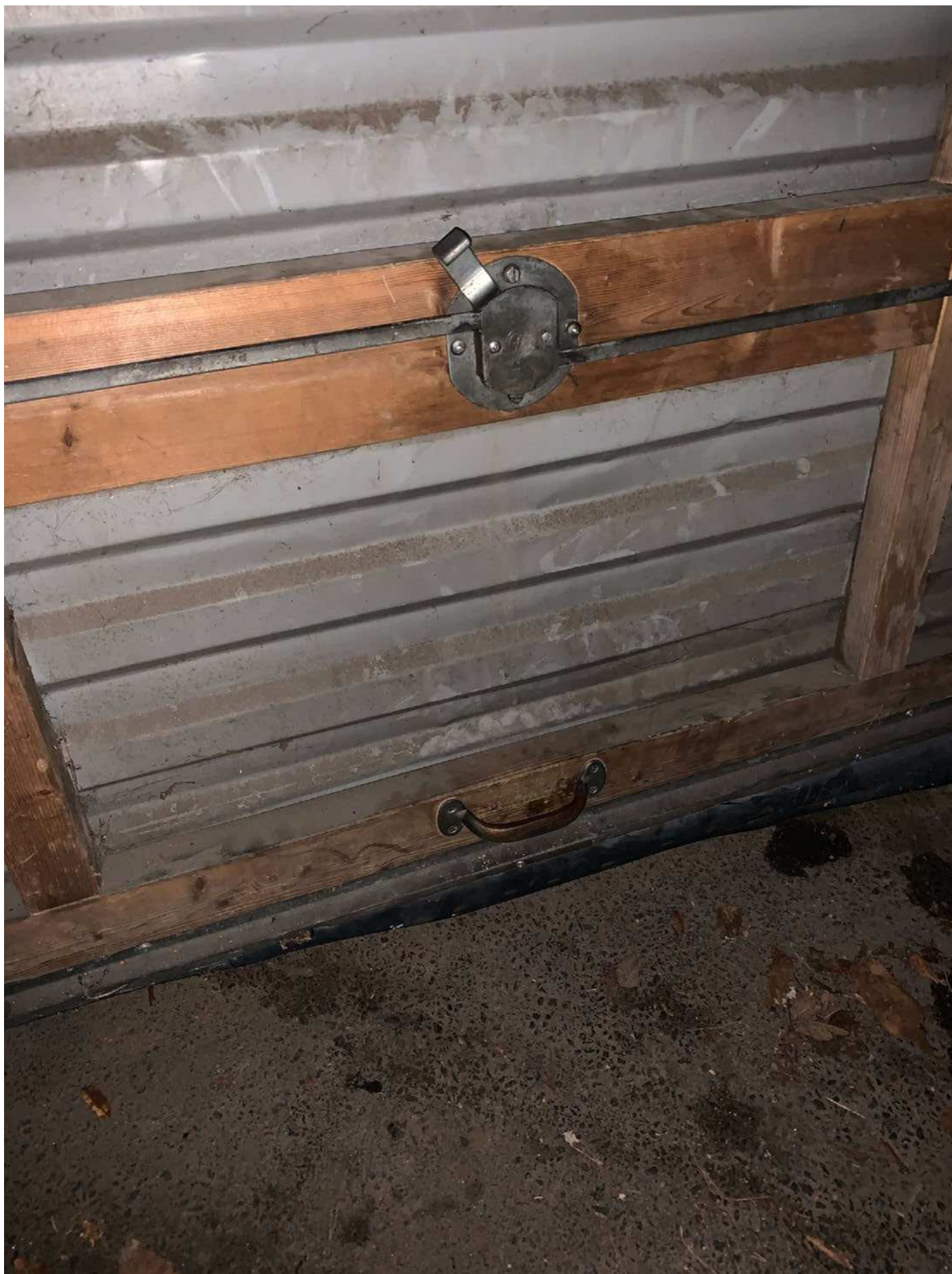
26. Spårsäkring Löpnr: 2 Dörrhandtag garage insida
