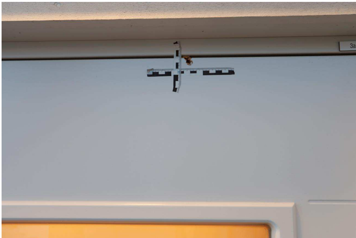
Figur 11. Närbild på skadan i dörren.
