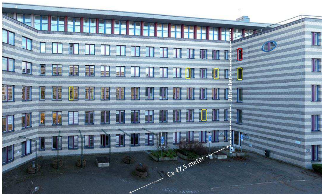
Figur 11. Röd rektangel markerar fönster där både yttre- och innerfönster var trasiga. Gula rektanglar visar där ytterrutorna var trasiga.
