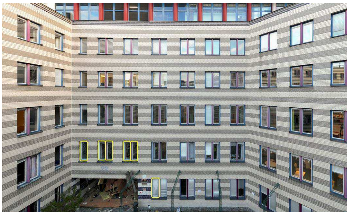
Figur 9. Gula rektanglar markerar fönster där endast ytterrutan var trasig.
