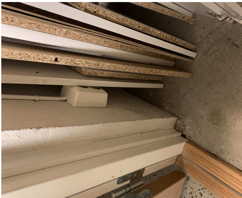
Foto taget i förråd tillhörande lgh 1101. Eluttag samt fläck på golvet.
