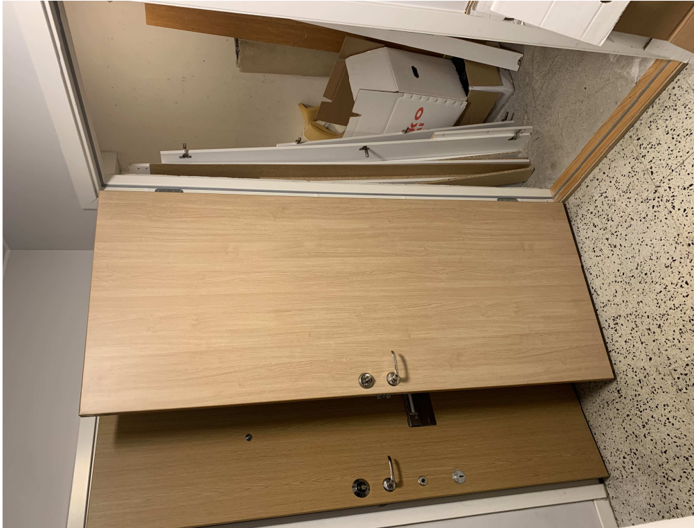
Foto taget mot förrådet tillhörande lgh 1101 Spelmanshöjden 6, med öppen förrådsdörr.
