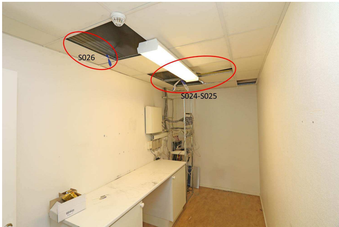
Bild 43: Kopplingsrum med packbord på våningsplan 3. Undersökta platser är markerade i bilden.
