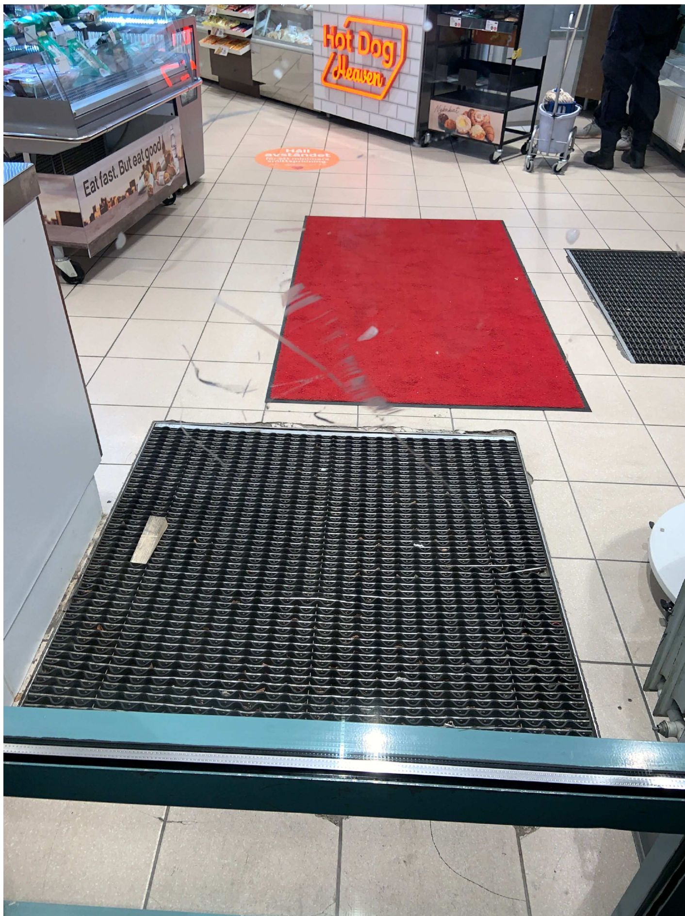
8. Foto taget på entrédörren som attackerats av gärningsmännen med stolar enligt vittne. Foto taget av Pa Olivia Fredriksson 2020-04-18 på Nybergs Torg 2 i Sundbyberg.
