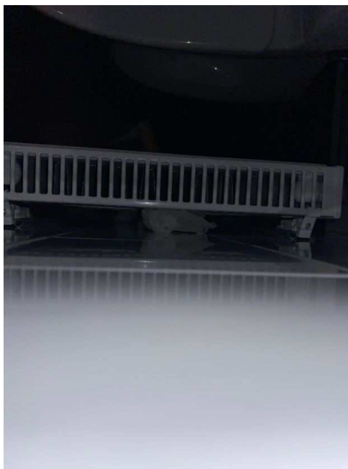
16. Plasthandskar bakom element i badrummet bredvid toaletten.
