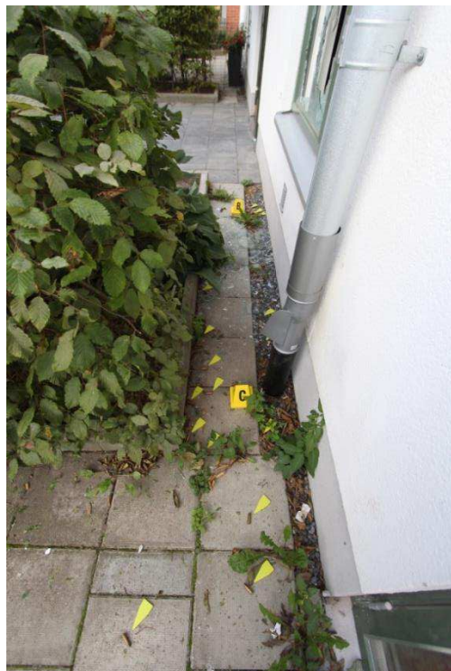
Figur 14: Marken mellan sovrumsfönstret och altandörren.
