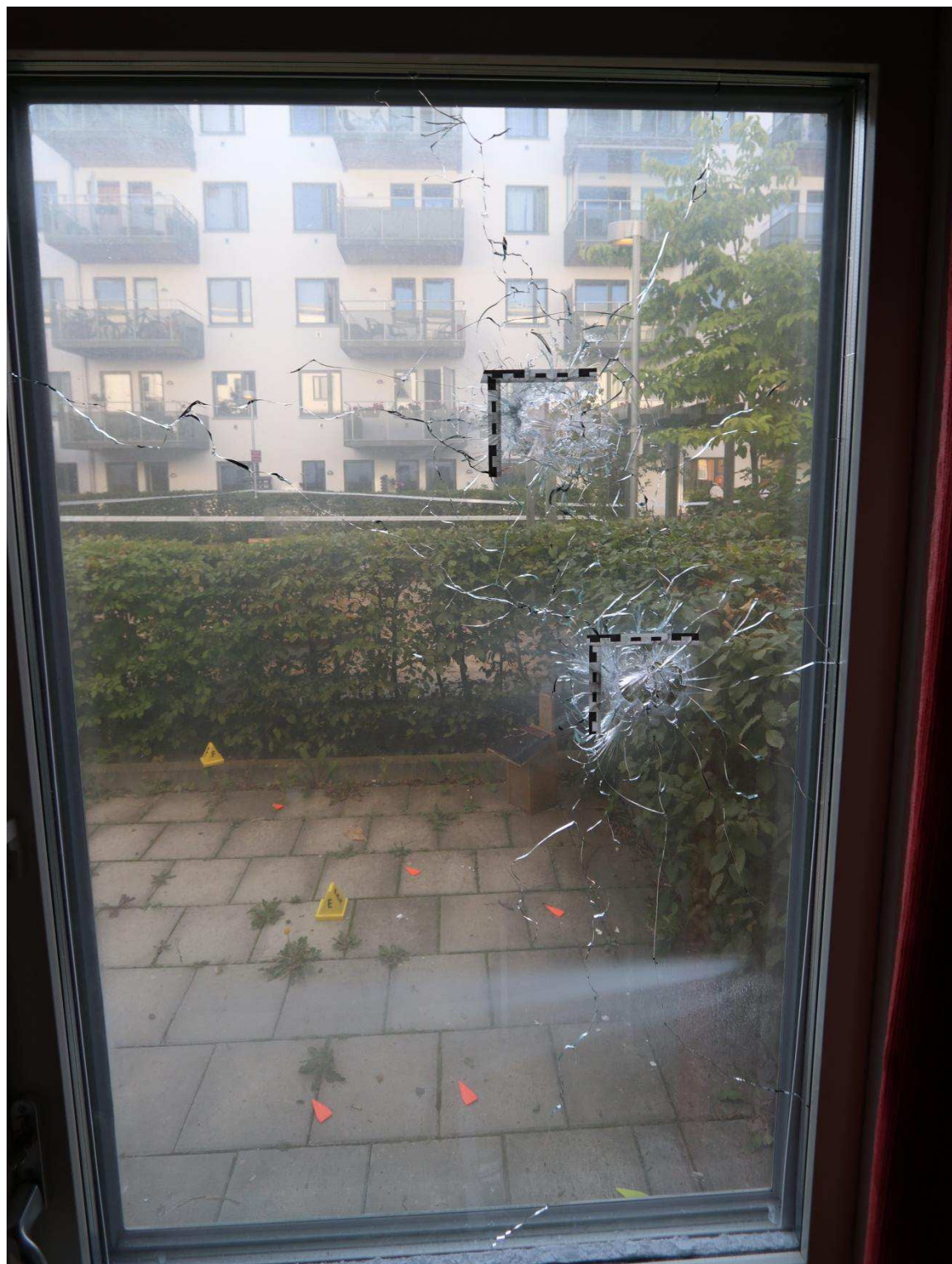
Figur 36: Kulhål i altandörrens fönster.
