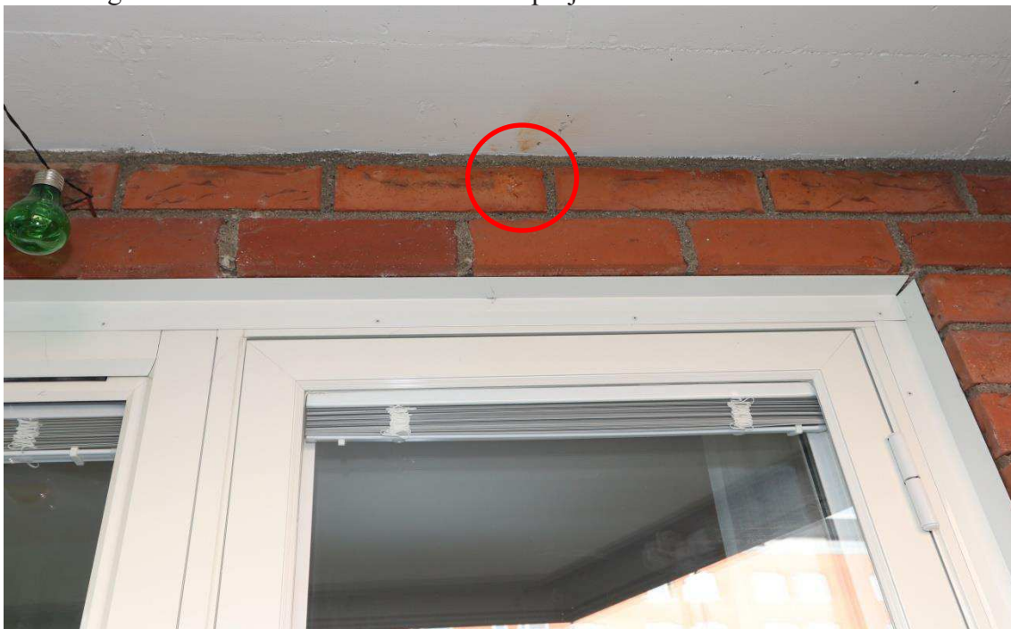
3. Islagsmärke i tegelväggen ovanför balkongdörren, markerat med röd cirkel.
