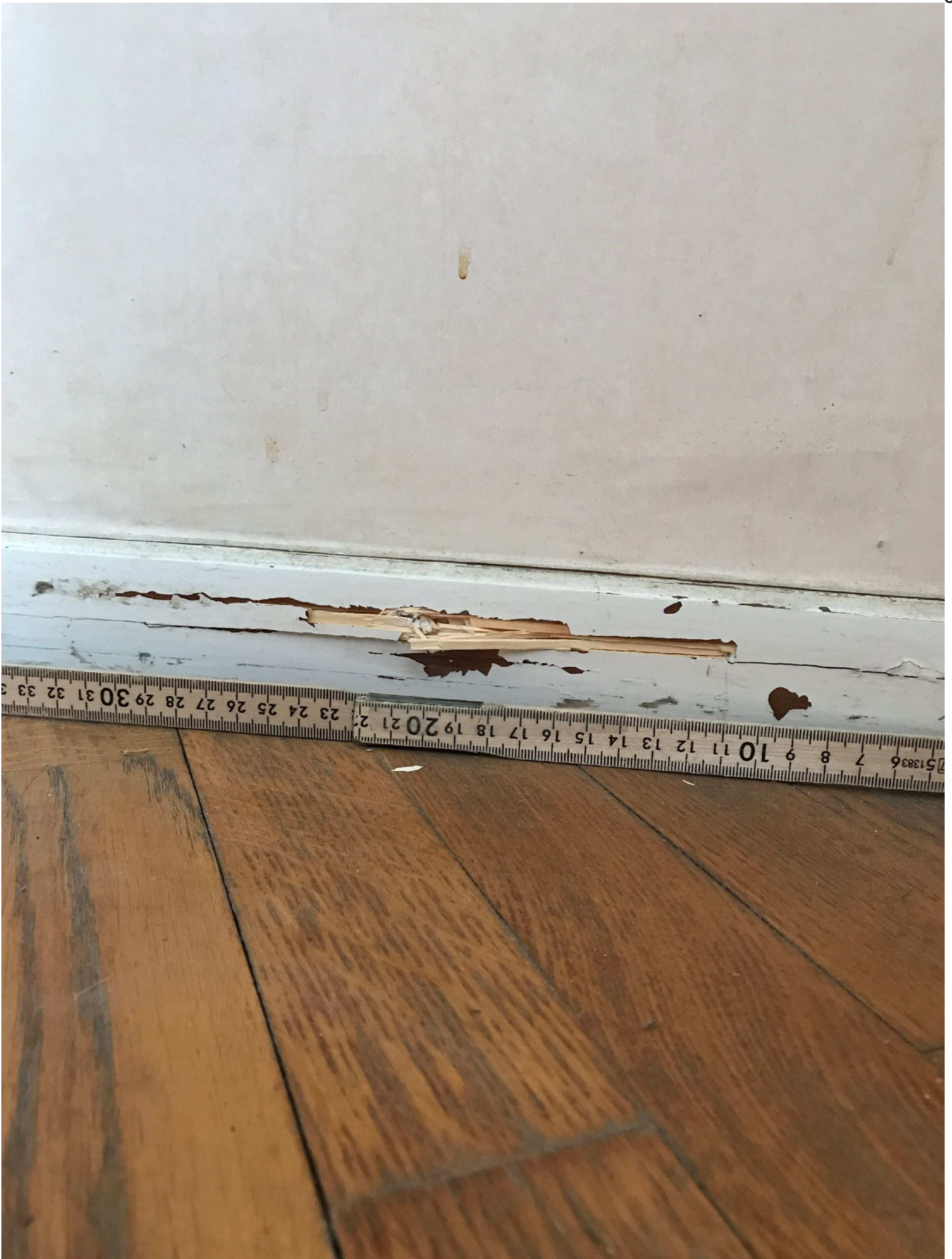
7. Skadan på golvsockeln
