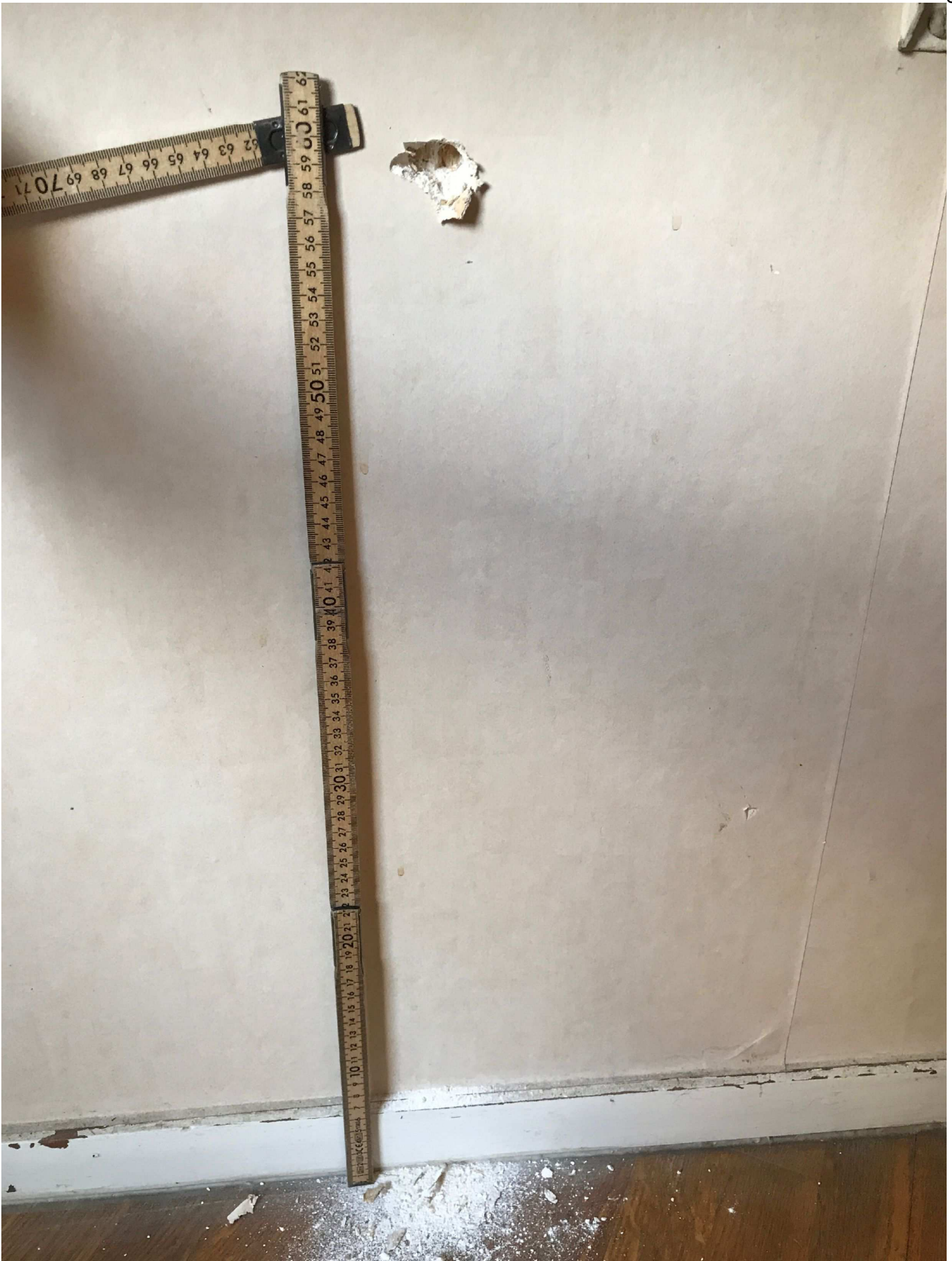
4. Skadan i väggen
