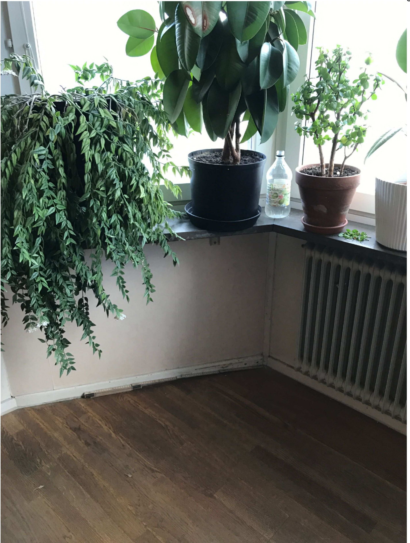
3. Vägg där kulan kommit in i lägenheten
