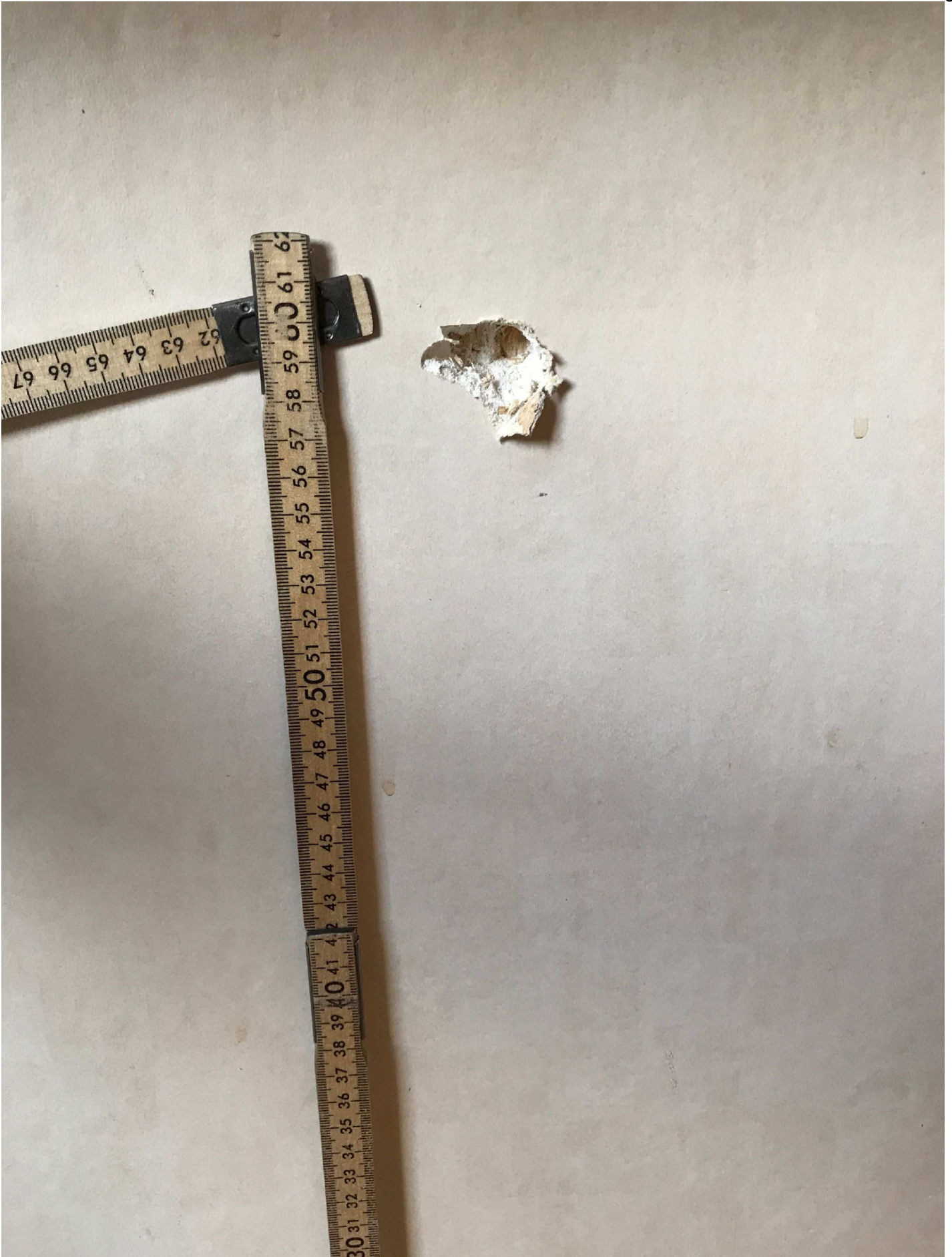
5. Skadan i väggen. Ca 59 cm upp från golvet
