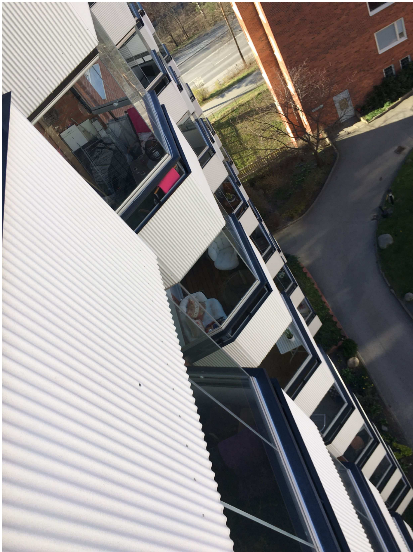
4. Bild på kulhål från balkongens utsida.
