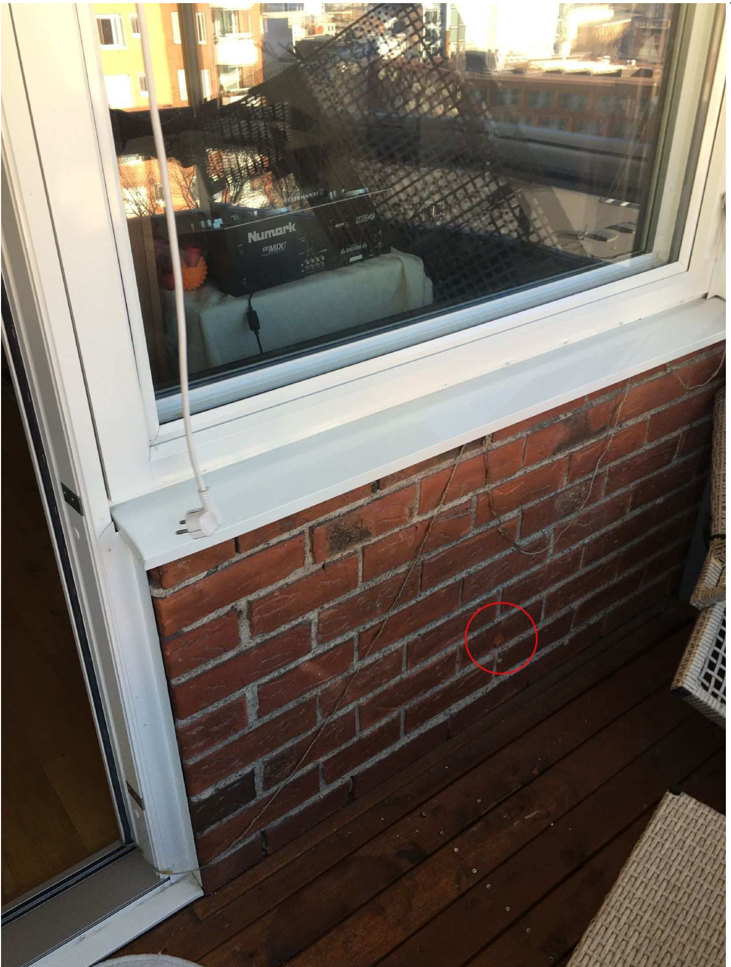
6. Översiktsbild på skada på tegelvägg under vardagsrumsfönstret (se röd markering). Vi fototillfället flyttade Ricky en soffa som placerats efter händelsen den 8 september.
