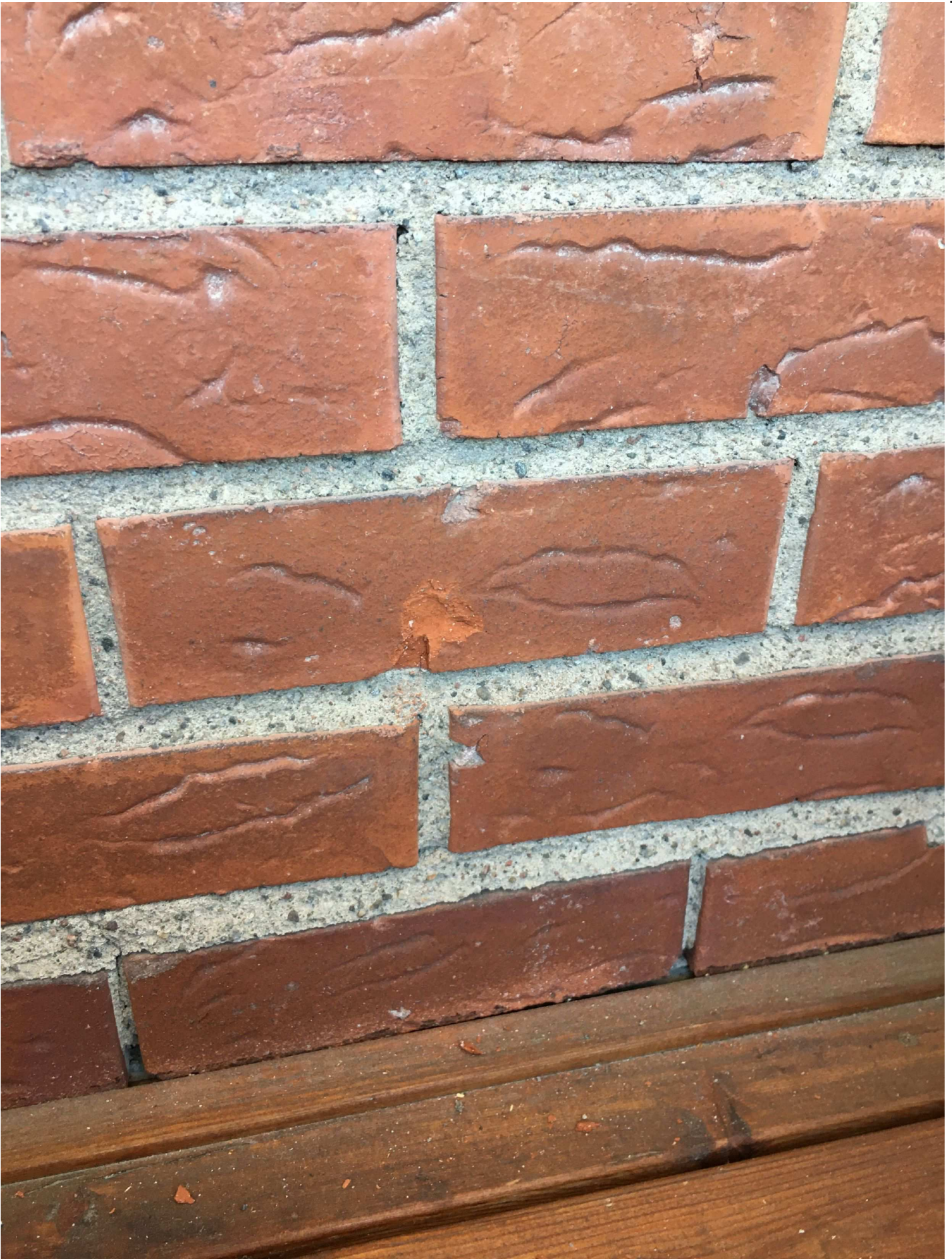
7. Närbild på skada på tegelvägg under vardagsrumsfönstret. Skadans placering är cirka 10-15 cm ovanför balkonggolvet.
