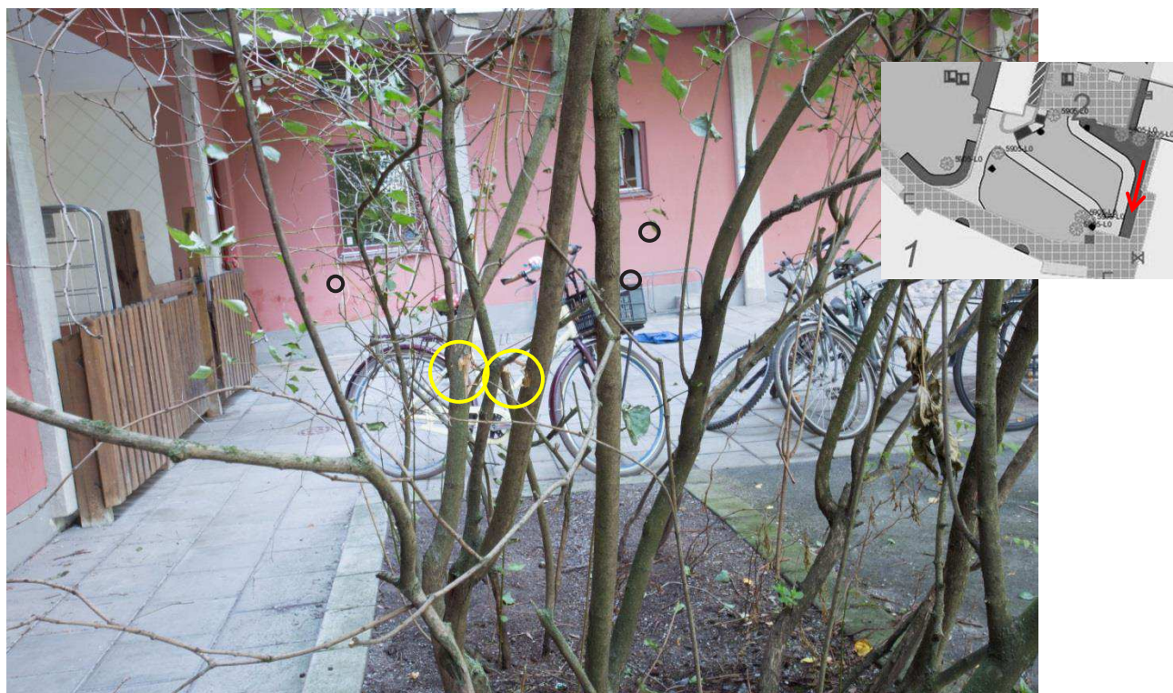
Bild 27: Skottskador i buskage närmare passage. Se även bild 25, 26. Svarta markeringar visar skador i fasad.
