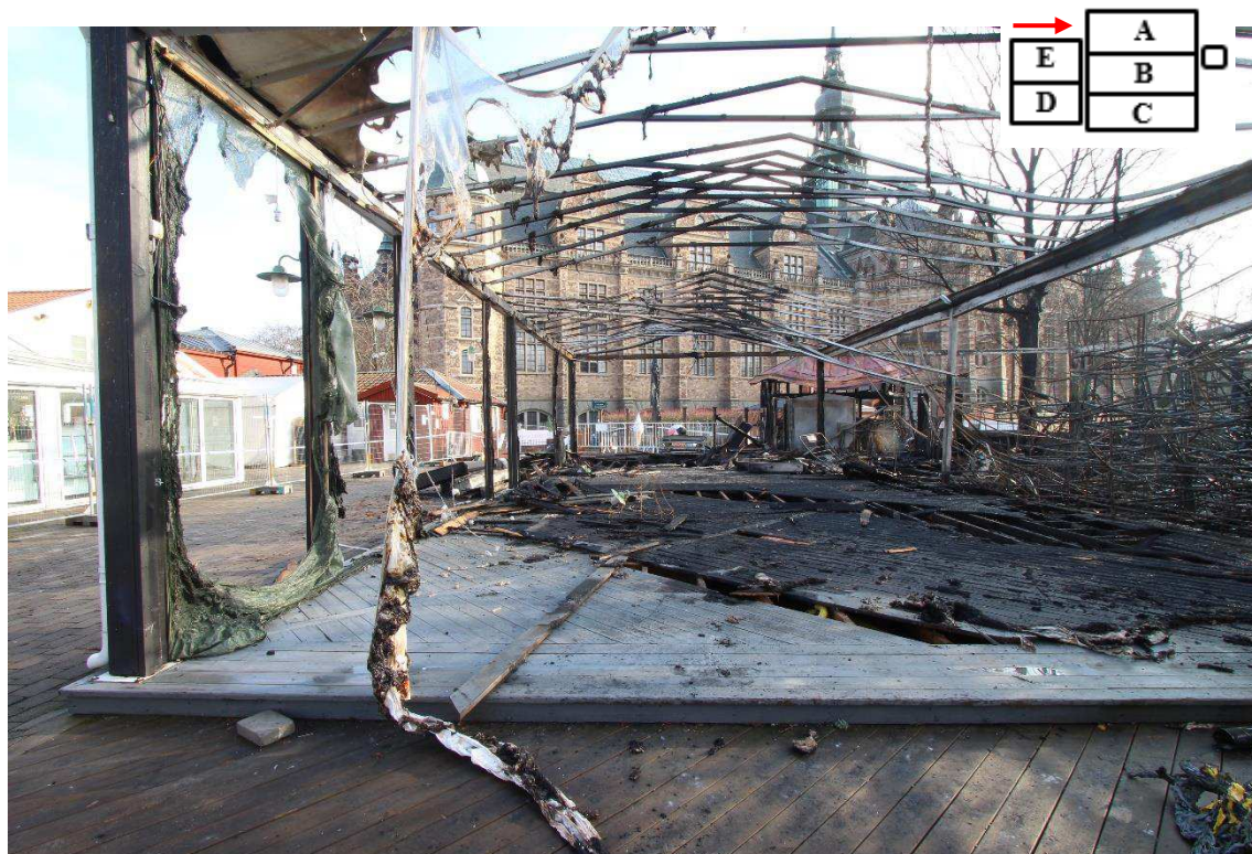
Figur 4. Sektion A sedd från den västra sidan där delar av golvet var opåverkat av brand och där mindre rester av tältduken fanns kvar. Röd pil på infogad orienteringsfigur visar ungefärlig fotoriktning.
