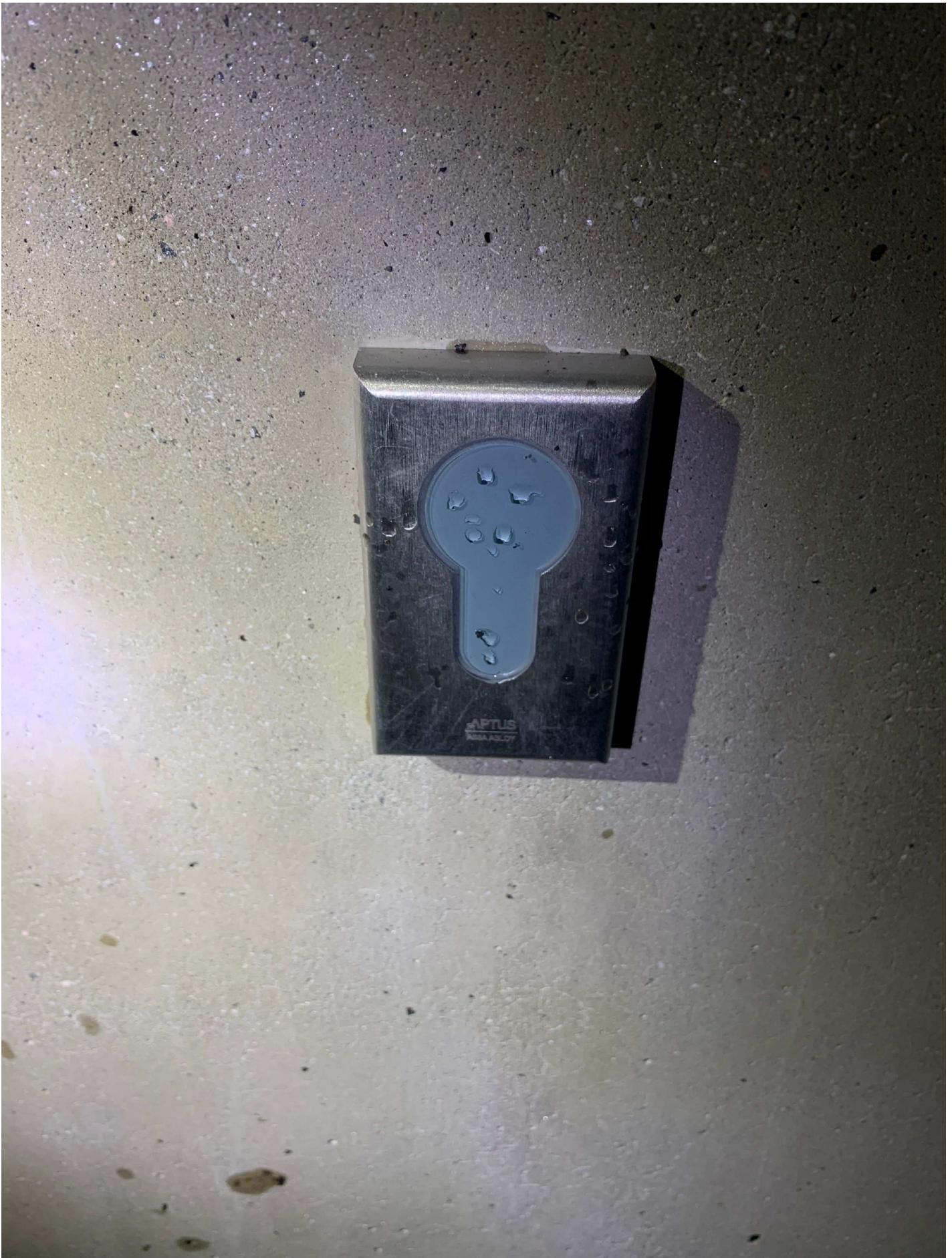
7. Blip som används för att öppna dörren till miljöstugan ifrån innergården.
