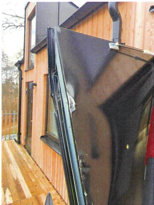
Skador på dörrbladets övre del, plåten har höger sida på flera ställen.
