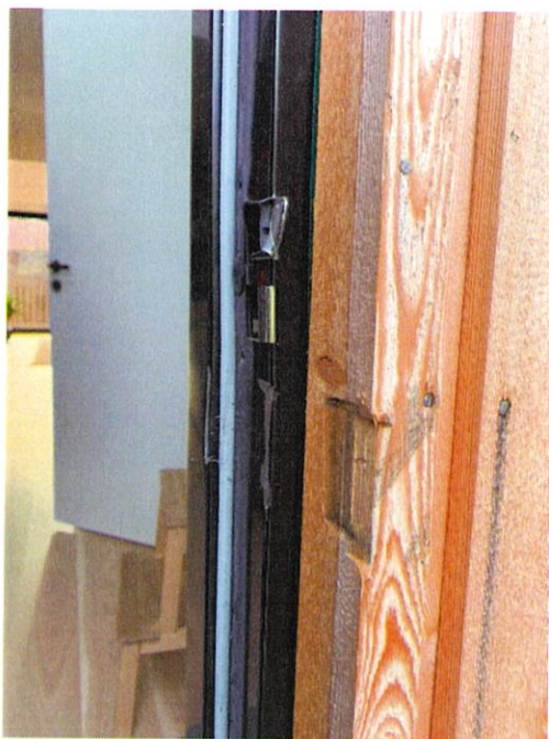
Skador på karm vid låspunkt.
