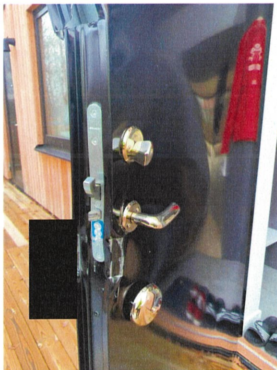
Skador på dörrbladet under handtaget.
