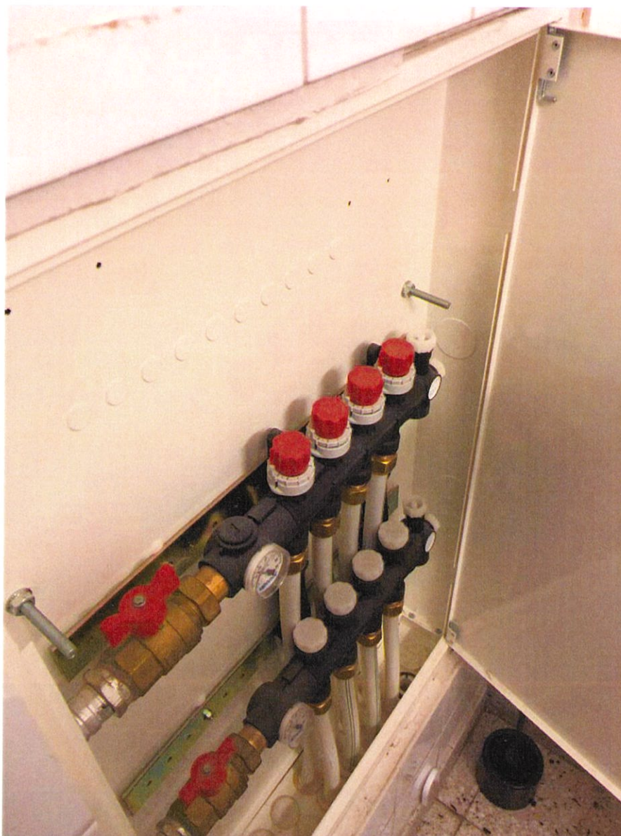
Vatteninstallation i plåtskåpet. Utrymmet är några centimeter djupt.
