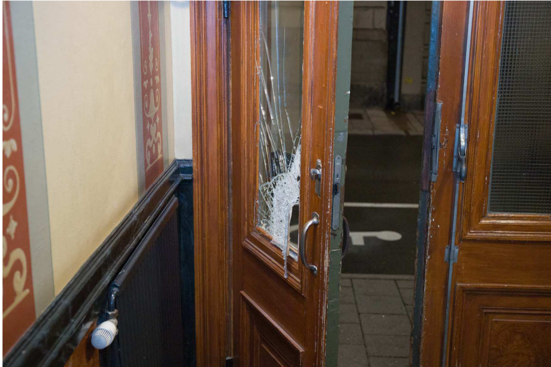
Bild 8. Den trasiga rutan i den högra dörren.
