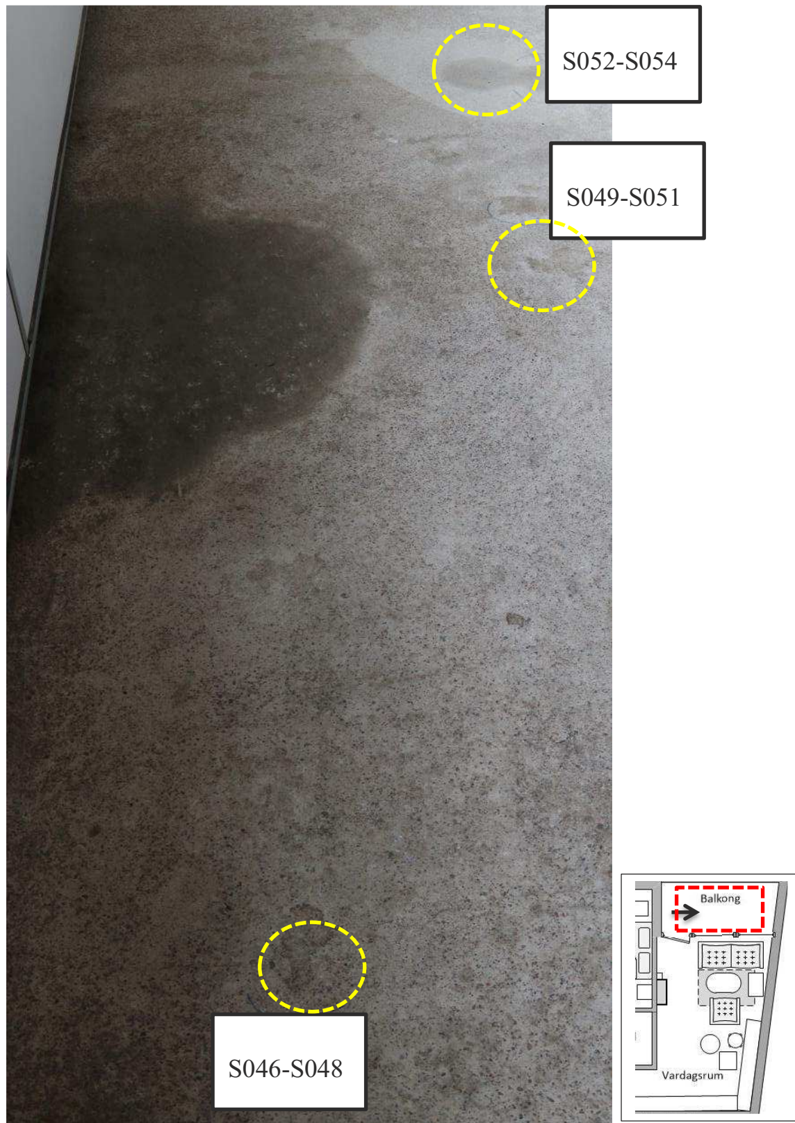
Figur 36. Balkonggolvet. De feta fläckarna där kriminalsökshundarna markerade är inringade. Från områdena topsades S046, S048, S049, S051, S052, S054 och på samma platser skrapades betong S047, S050, S053 bort.
