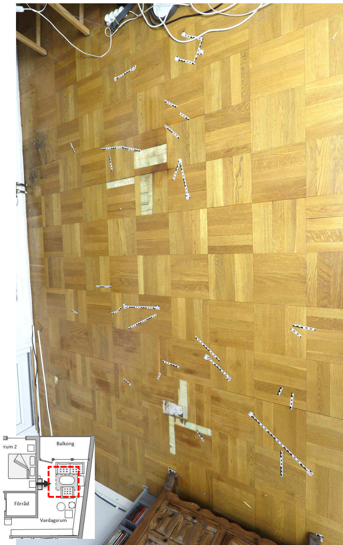
Figur 33. Samma golvyta som i figur 29, här fler markeringar av skadorna i golvet gjorts.
