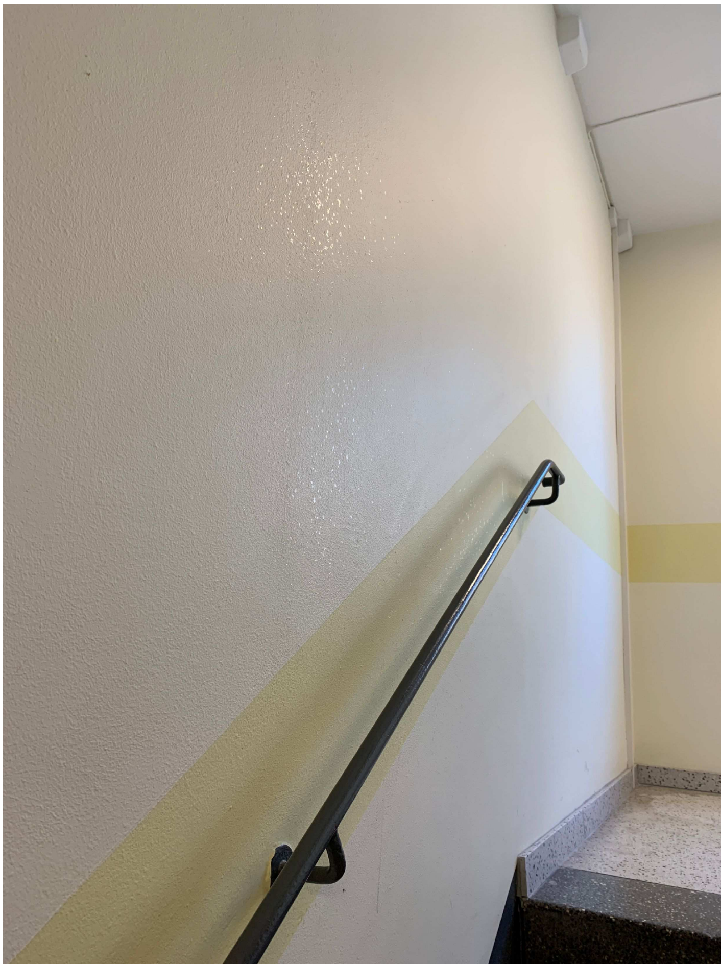
2. Trappuppgång Mercuriusvägen 1, vägg med stänk av oklar vätska. Mellan våning 1 och 2.
