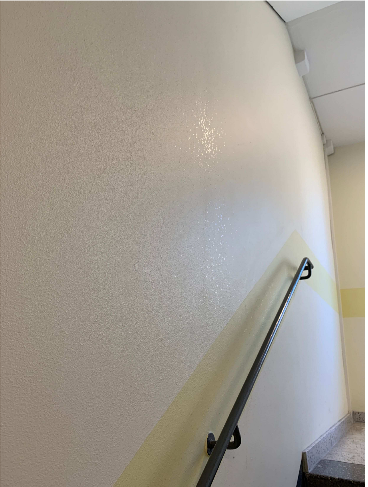
1. Trappuppgång Mercuriusvägen 1, vägg med stänk av oklar vätska. Mellan våning 1 och 2.
