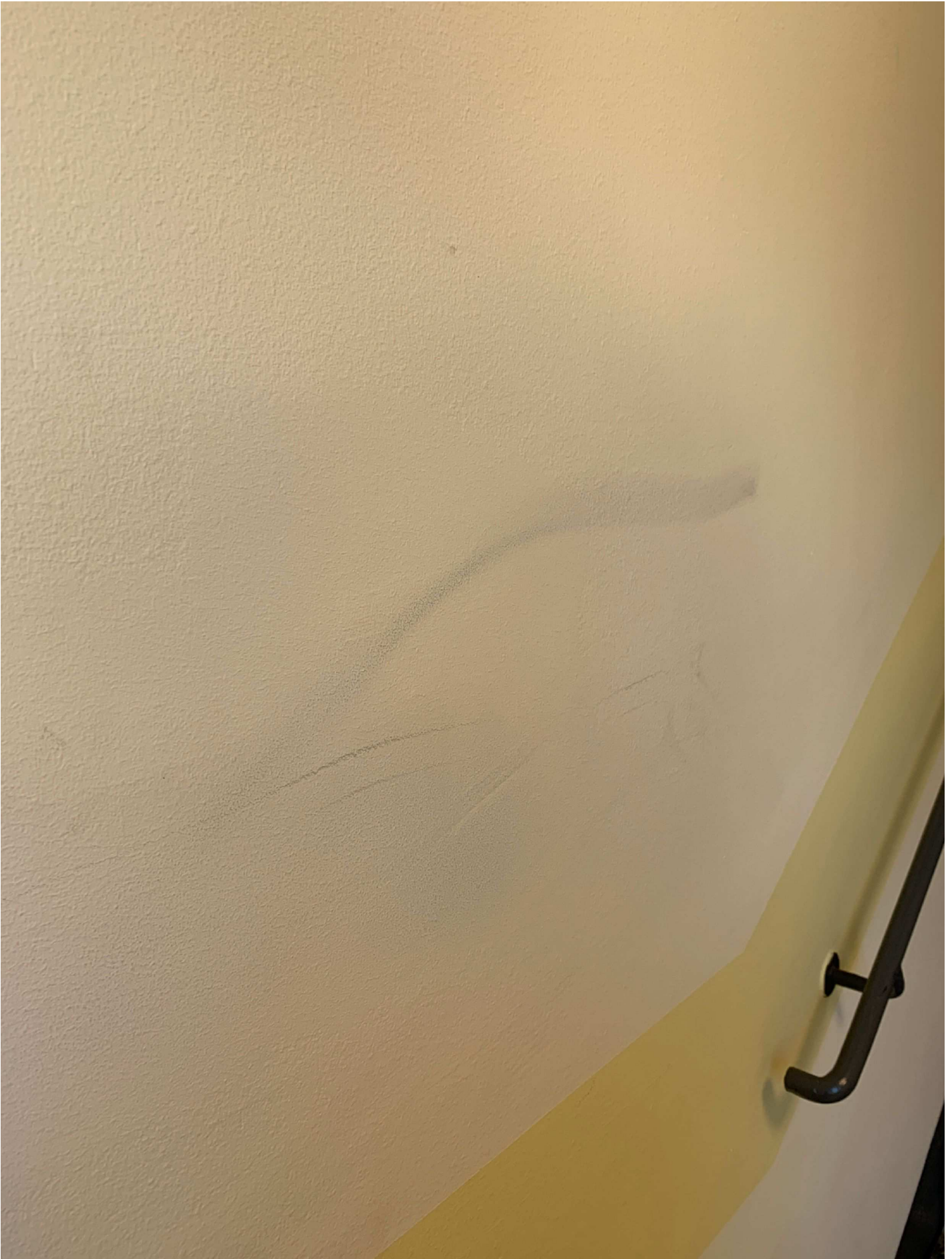
5. Mörkt streck i trappuppgång Mercuriusvägen 1. Mellan våning 1 och 2.
