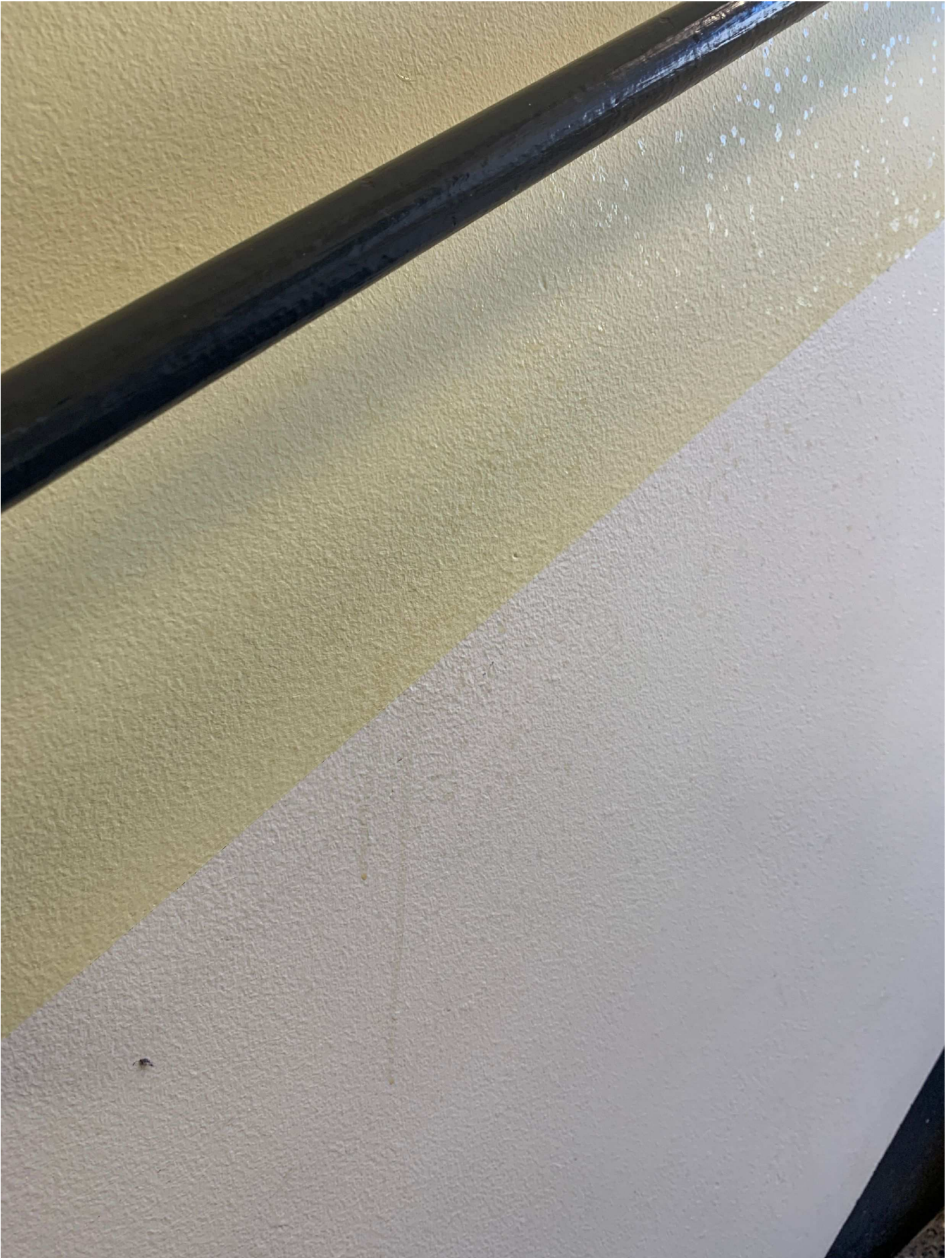
4. Trappuppgång Mercuriusvägen 1, vägg med stänk av oklar vätska. Mellan våning 1 och 2.
