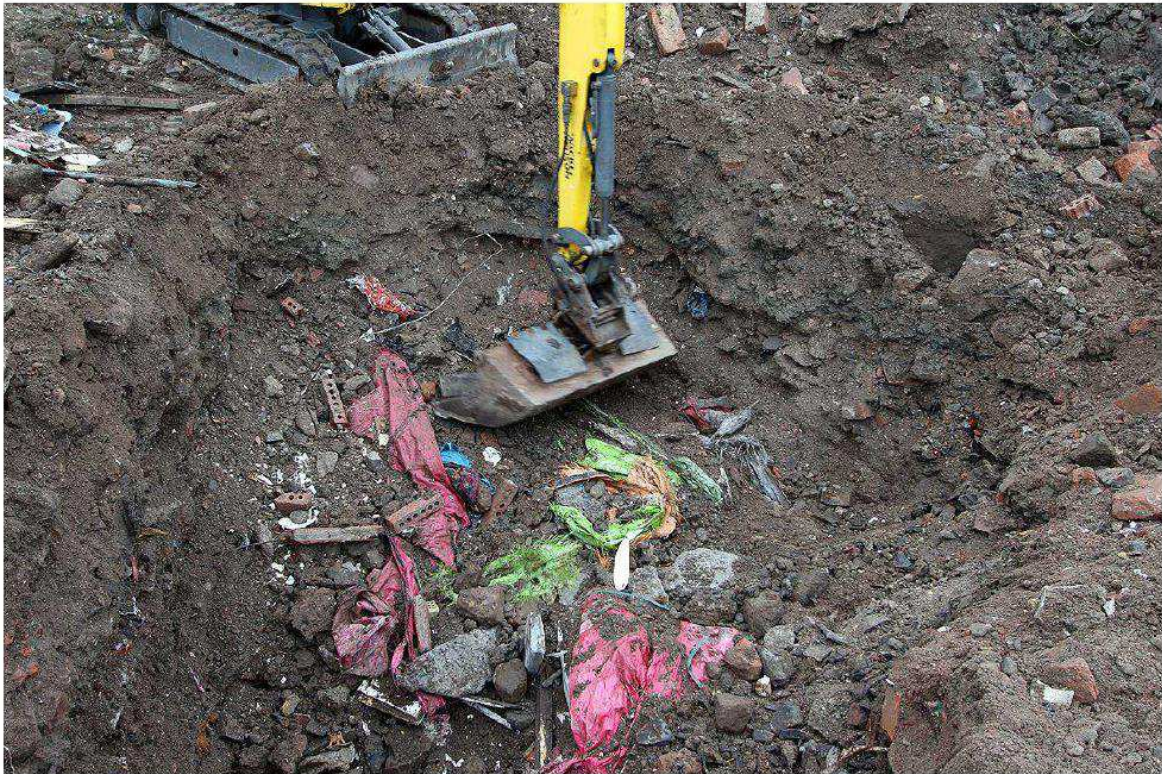
Figur 11 Grop 2 Ytterligare avfallssäckar med rivningsavfall med gips- och betongbitar påträffades i gropen.
