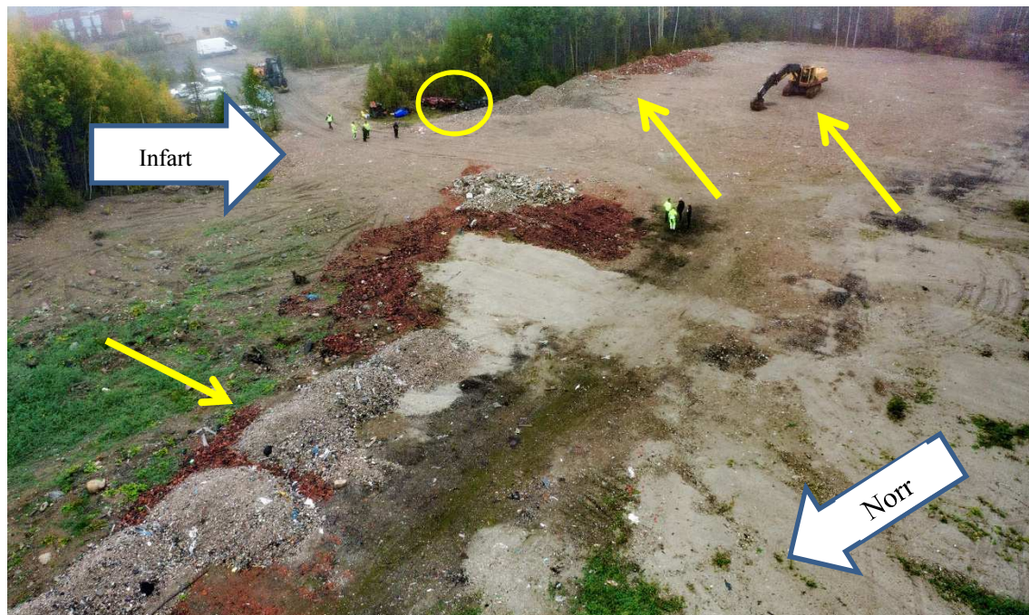
Bild 3. Skrotbilarna vid infarten är inringade. Pilarna pekar mot dumpningshögar. I bilden syns grävmaskinen.
