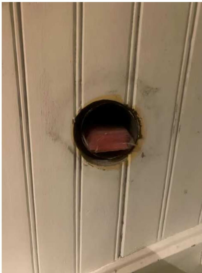
13. Hålet i väggen där redline-påsarna påträffades.
