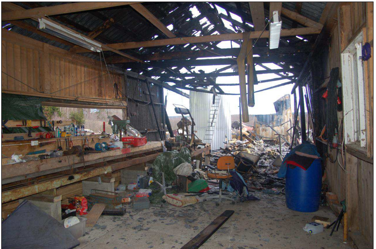
Bild 12. Inne i brandskadad byggnad.
