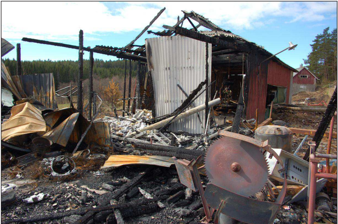
Bild 15. Bild tagen utifrån på brandskadad byggnad.
