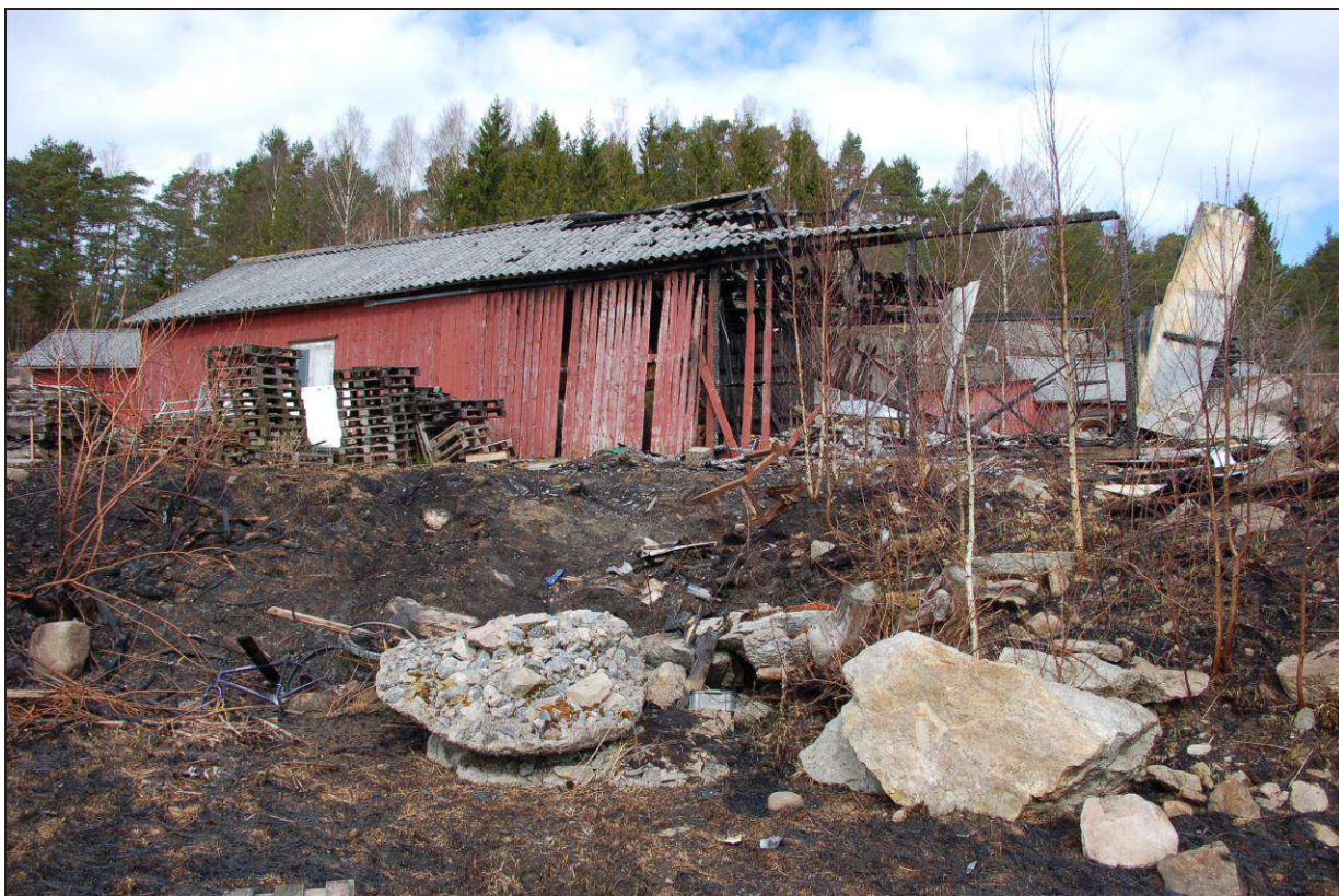
Bild 8. Bild tagen nedanför brandskadad byggnad.
