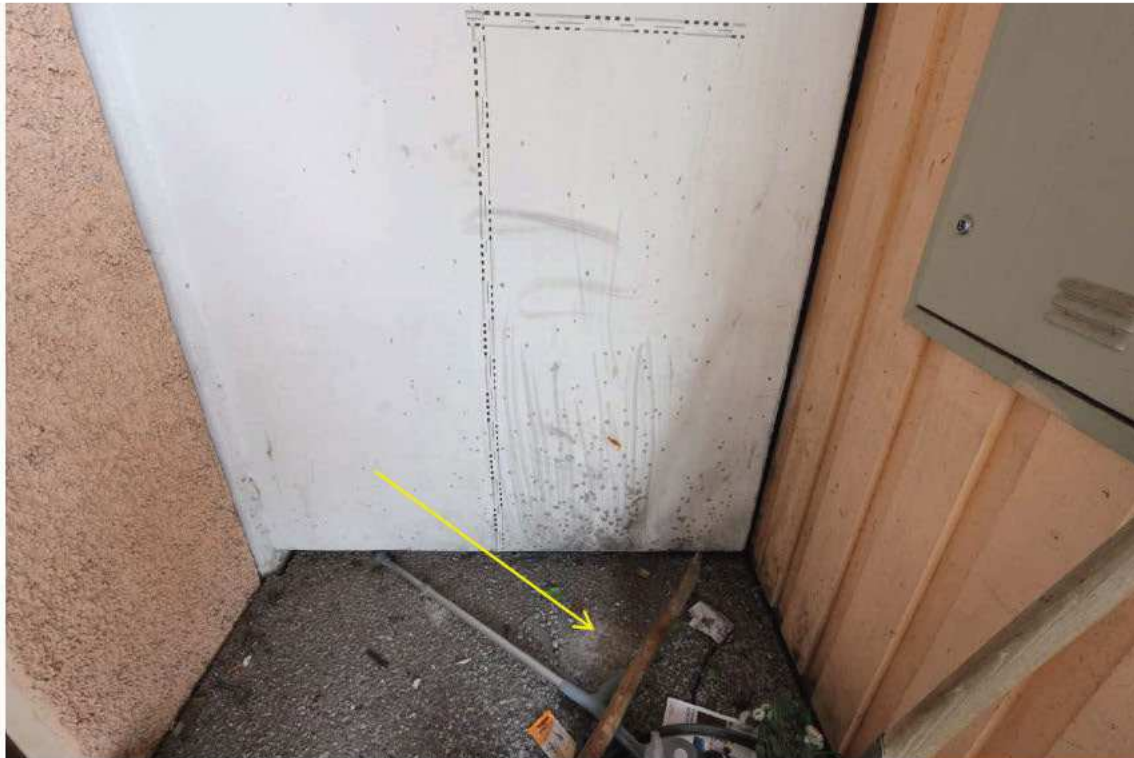
Figur 6. Krevadgropen och vägg med tydliga splitterskador. Gul pil markerar krevadgropen.
