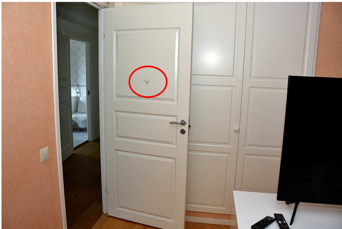
Figur 19. Sovrumsdörren med skada markerad.
